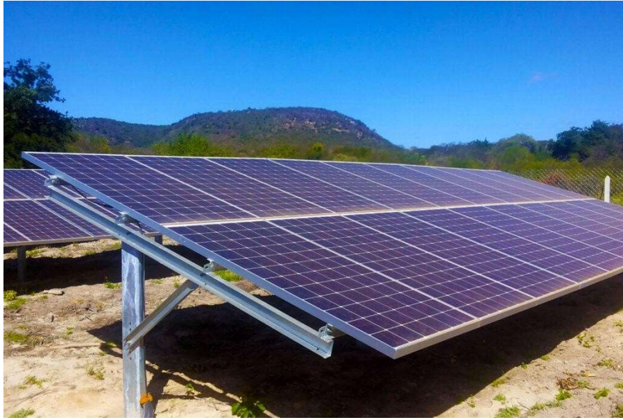
Figura 13 - Usina solar fotovoltaica com estrutura solo de inclinação fixa.
