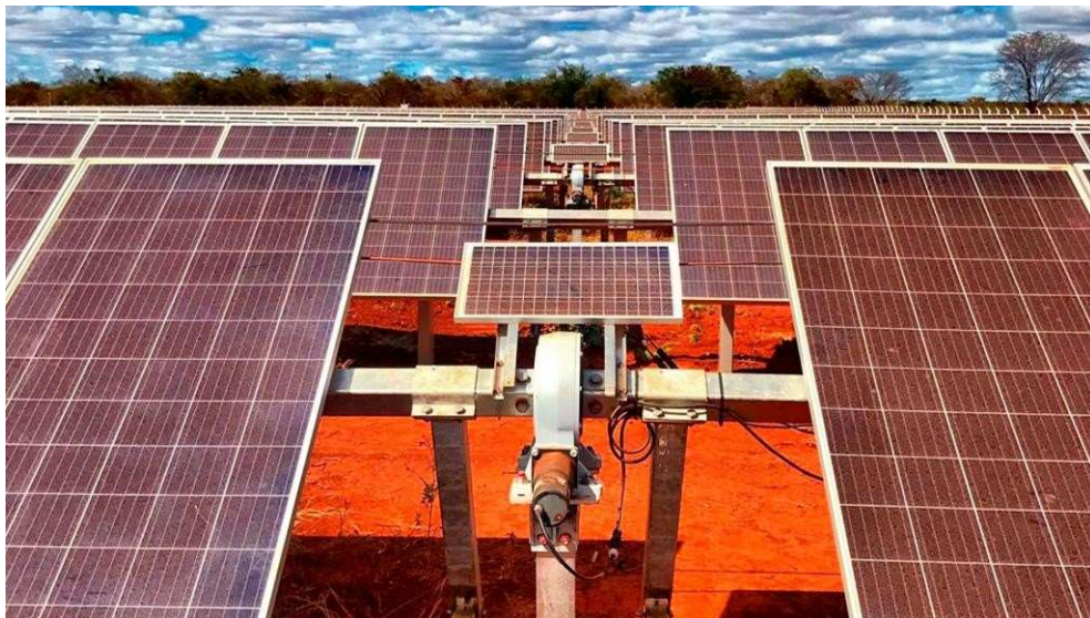
Figura 21 - Usina fotovoltaica com estrutura de rastreamento de um eixo.
