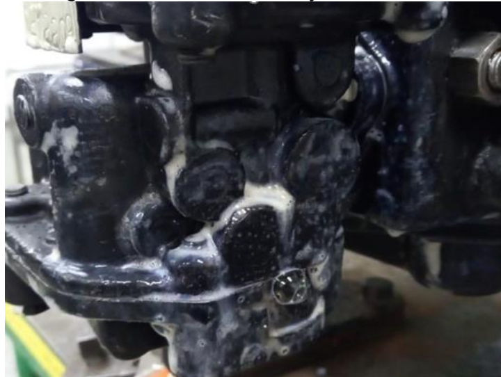
Figura 25 - Vazamento na junta da válvula
