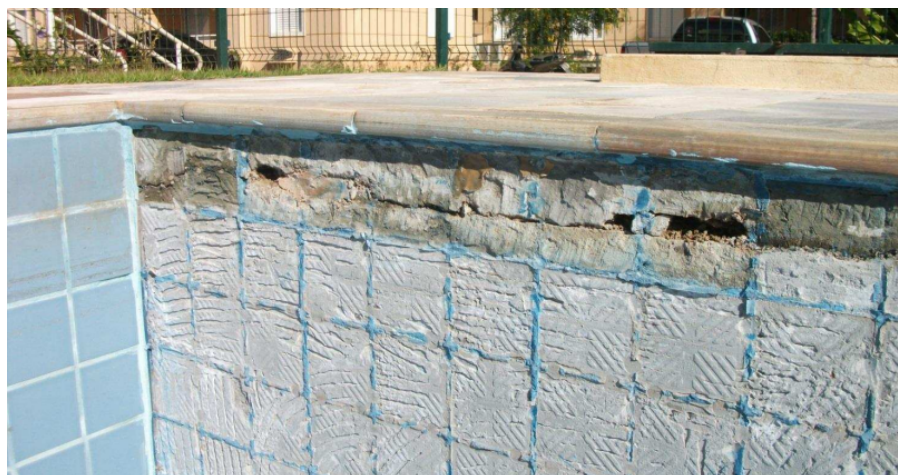
Figura 14 – Processo de fissuração por recalque da estrutura
