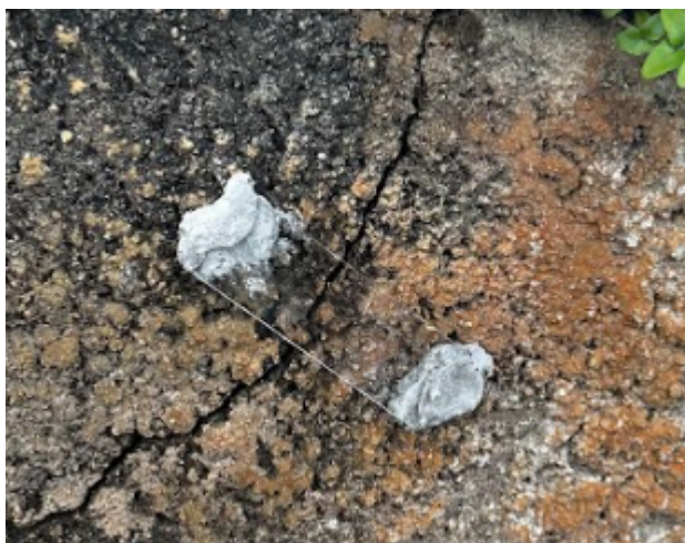
Figura 52 – Monitoramento de fissura
