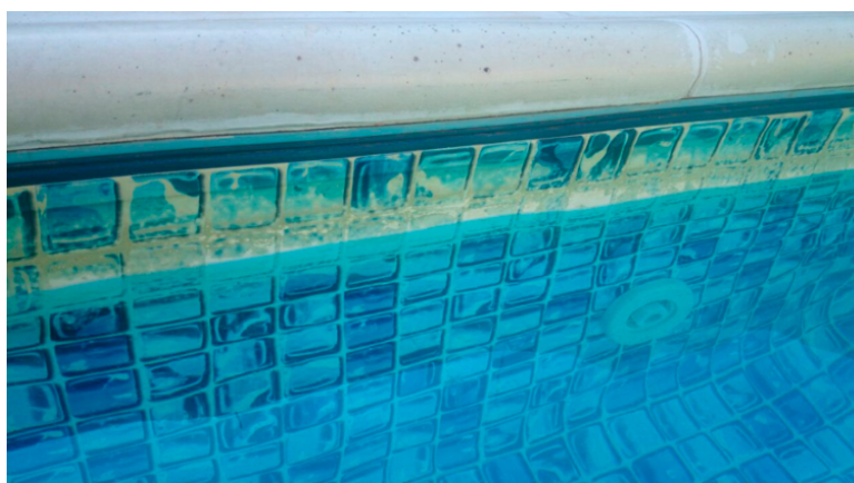
Figura 25 – Descoloração do revestimento acima do nível da água
