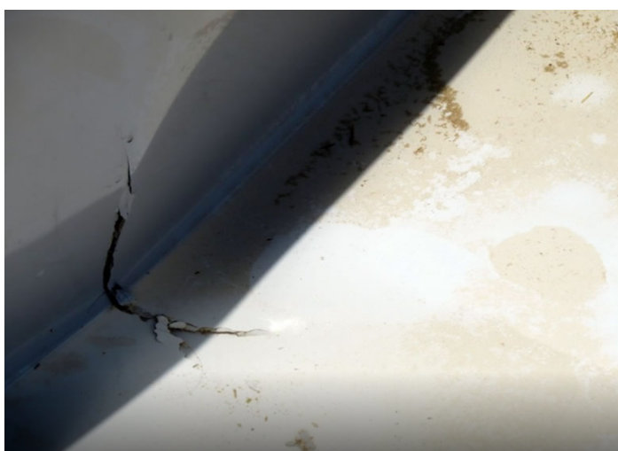
Figura 30 – Rachadura em piscina de fibra de vidro
