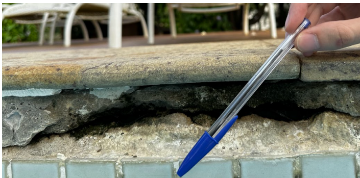
Figura 42 – Comparação de tamanho da fissura com uma caneta
