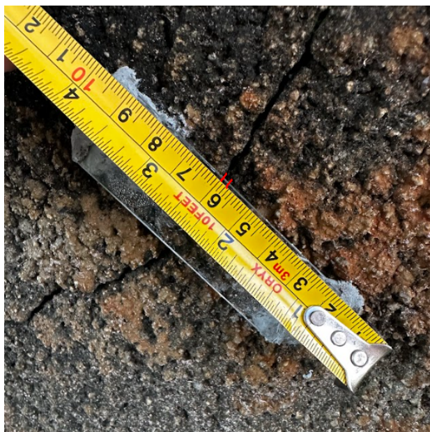
Figura 51 – Fissura com 2 mm de abertura
