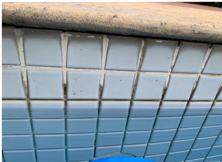
Figura 44 – Degradação do rejunte abaixo do nível da água
