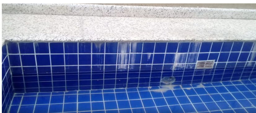
Figura 20 – Eflorescência no revestimento de piscina
