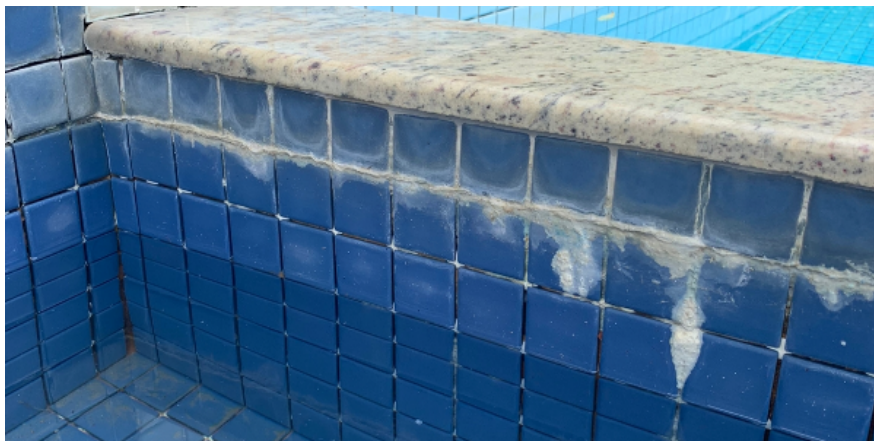
Figura 46 – Eflorescência aflorando pelas juntas de assentamento
