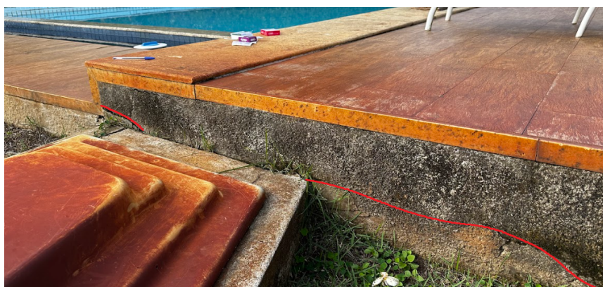
Figura 47 – Fissura inclinada no lado direito da face sul da estrutura do deck da piscina
