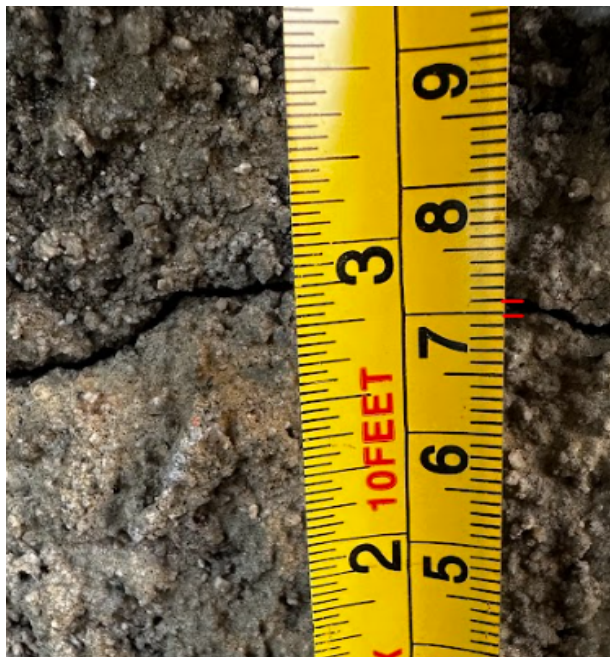
Figura 50 – Fissura com 1mm de abertura
