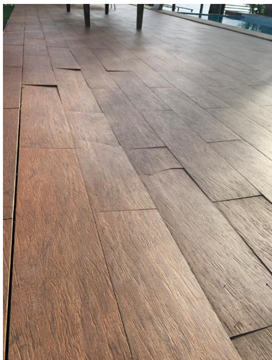
Figura 49 – Afundamento do deck da piscina
