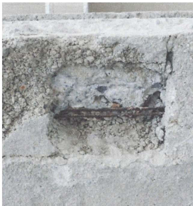
Figura 21 – Corrosão da armadura na estrutura de uma piscina
