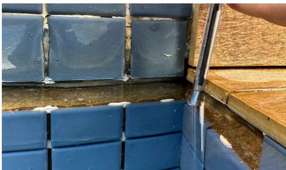
Figura 41 – Fissura horizontal no encontro da face leste com a sul
