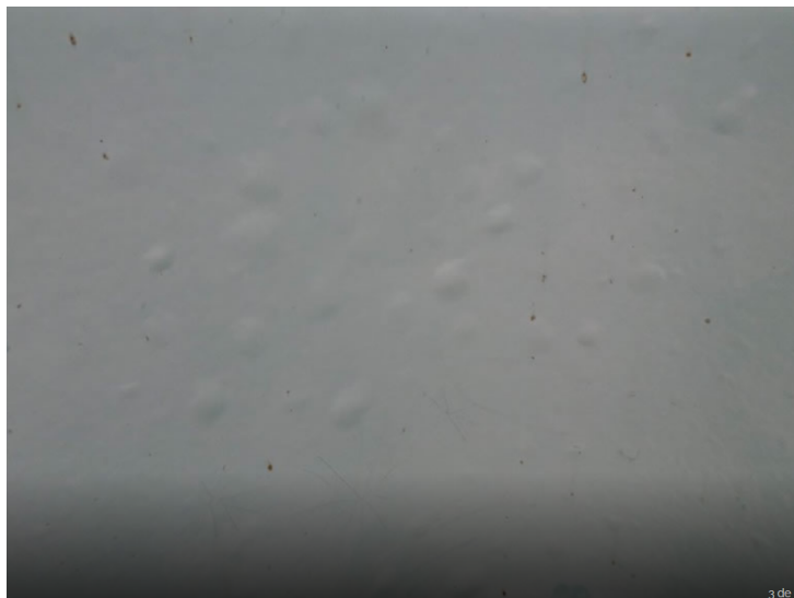
Figura 29 – Bolhas na superfície do revestimento de fibra de vidro
