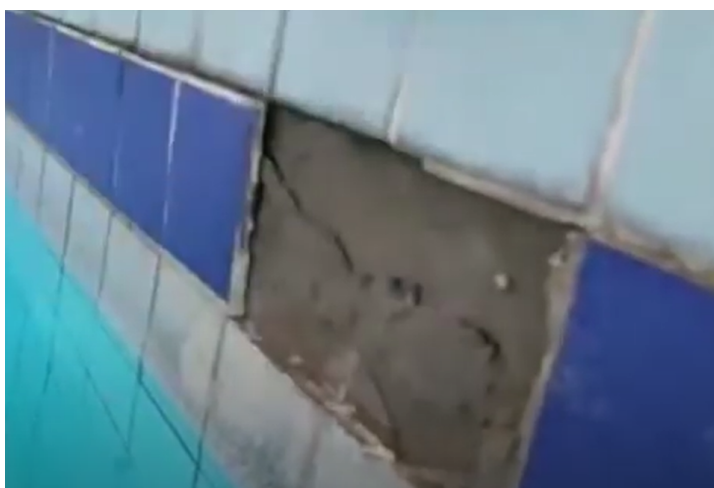
Figura 16 – Deslocamento por perda de aderência com a argamassa
