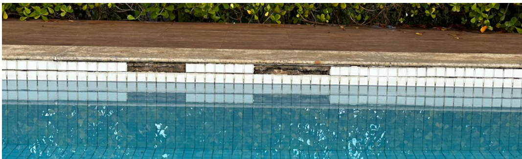
Figura 39 – Fissura horizontal na face oeste da piscina
