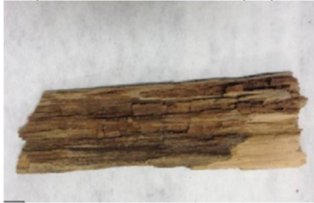
Figura 2 – Aspecto da madeira acometida por podridão parda.
