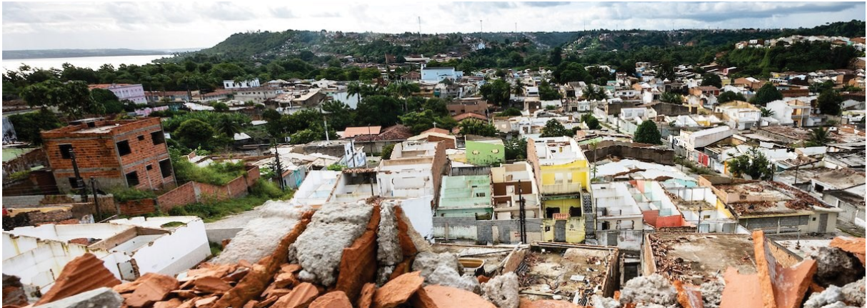
Figura 1: Áreas dos bairros de Mutange e de Bebedouro desocupadas e destruídas após desastre socioambiental causado pela exploração de sal-gema.
