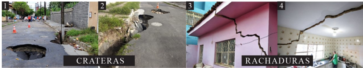
Figura 13: Crateras nas ruas e rachaduras em edifícios causadas pela subsidência de solo.
