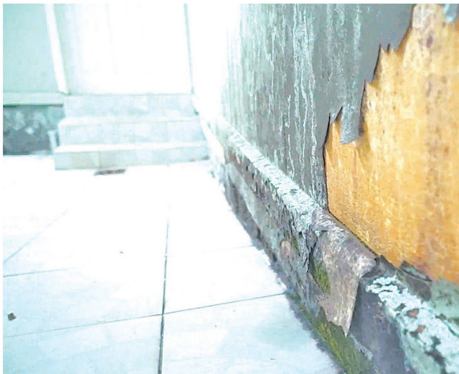
Paredes antigas na estrutura da maternidade começam a descascar e sofrer com a umidade
