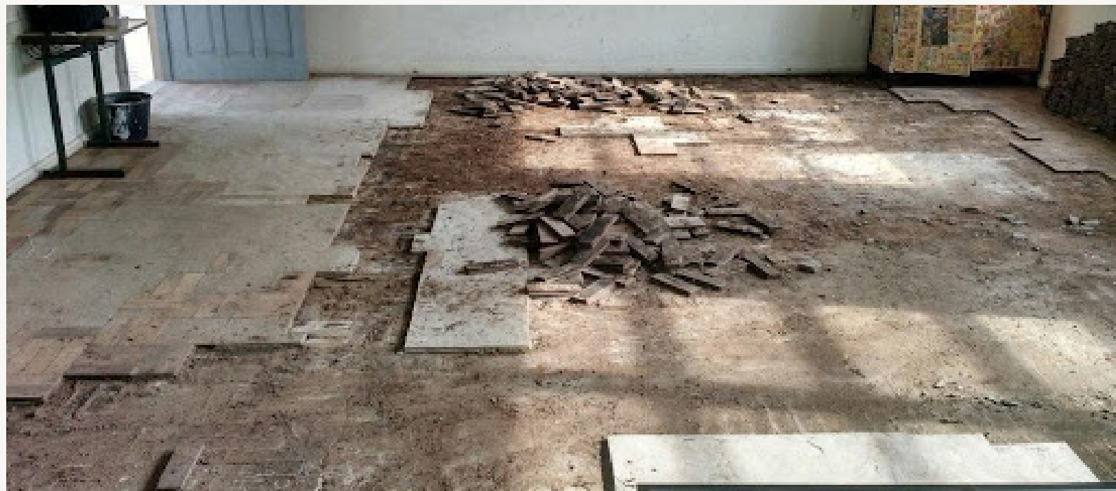
Figura 1. Fotografia da sala de aula deteriorada da escola. Fonte: arquivo pessoal.
