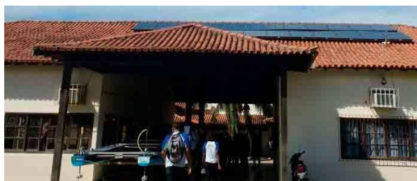
Figura 17: Placa Fotovoltaica instalada no telhado do Colégio Municipal Paulo Freire. Fonte: Autores, 2017.
