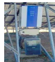
Figura 16: Placas Fotovoltaicas- APAE. Fonte: Autores, 2017.
