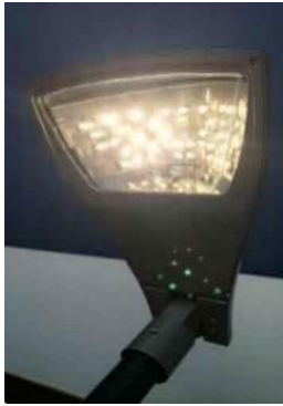
Figura 21: Luminária de LED. Fonte: Autores, 2015.
