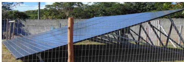
Figura 15: Placas Fotovoltaicas- APAE. Fonte: Autores, 2017.
