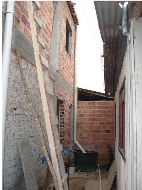
Figura 7: Coletor de águas fluviais. Fonte Autores
