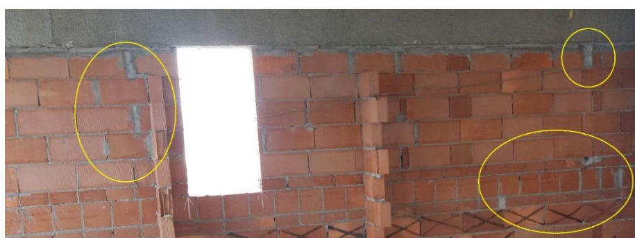
Figura 4: Sobre-espessura da argamassa de assentamento. Fonte: elaborado pelos autores.
