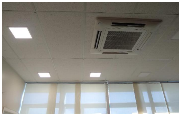
Figura 5- Ambiente corporativo com destaque para cortina tipo tela, forro fibra mineral, luminária de LED e Evaporador VRF- Fonte: Acervo das autoras
