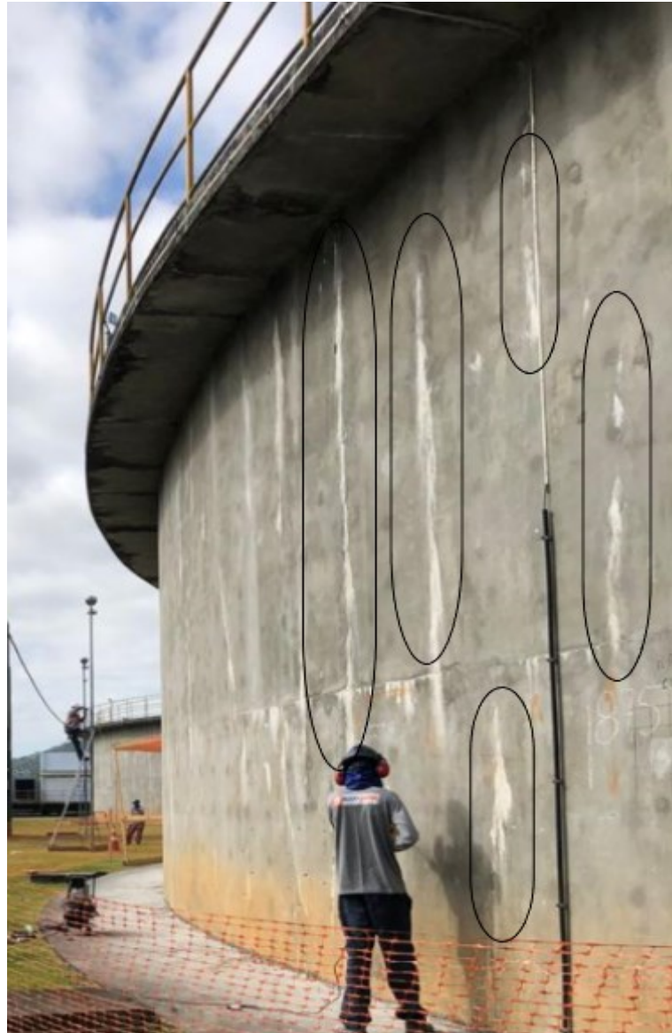
Figura 43 - Eflorescência do concreto nos reservatórios
