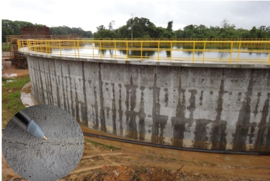
Figura 42 - Fissuras dos reservatórios
