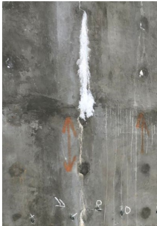
Figura 16 - Eflorescência e carbonatação em fissura
