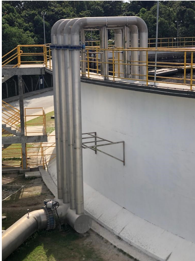
Figura 39 - Tubulações para distribuição de oxigênio nos reatores
