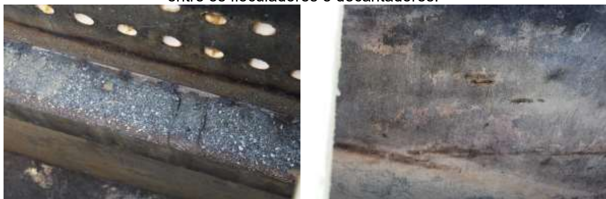
Figura 62 – Regiões com focos de corrosão da armadura nas paredes da região entre os floculadores e decantadores.
