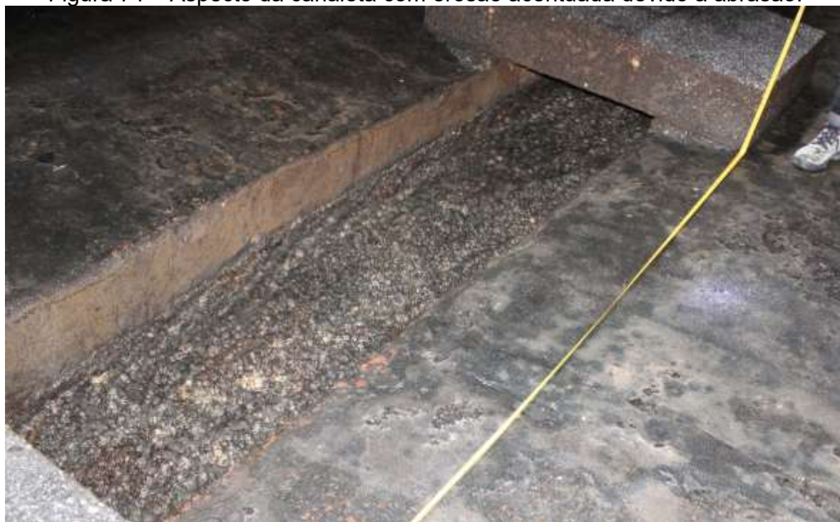
Figura 74 – Aspecto da canaleta com erosão acentuada devido a abrasão.
