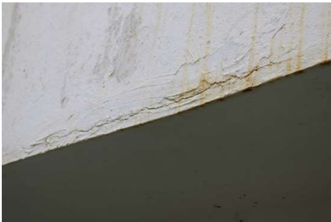
Figura 51 - Fissura característica de processos de corrosão na armadura, ocasionada por falhas na impermeabilização, permitindo a infiltração de água na estrutura
