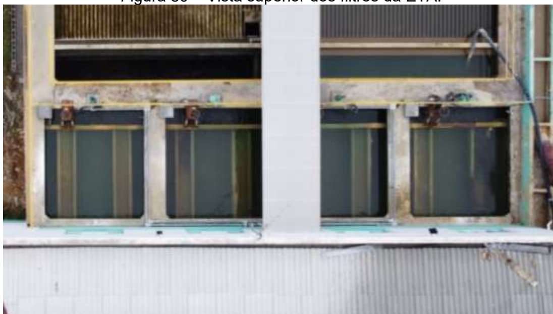
Figura 80 – Vista superior dos filtros da ETA.
