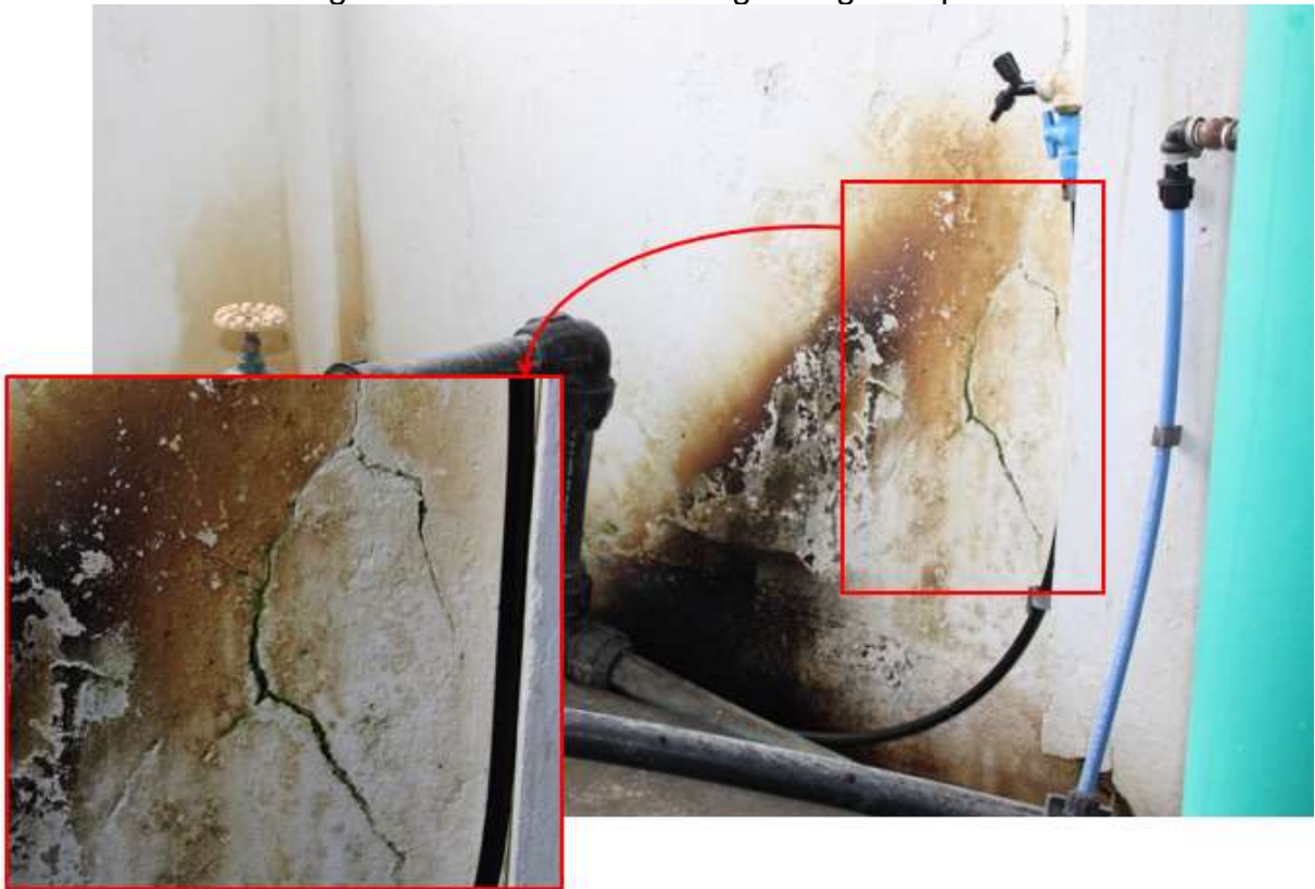
Figura 101 – Fissuras de origem higroscópica.
