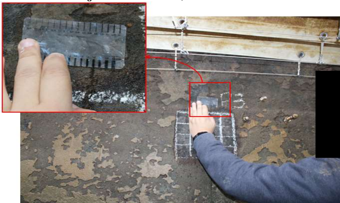
Figura 79 – Fissura de 1,8 mm na Parede A.
