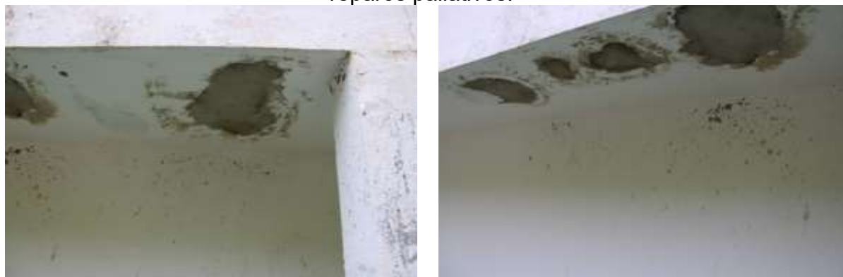
Figura 52 – Regiões com focos de corrosão da armadura nas quais foram realizados reparos paliativos.
