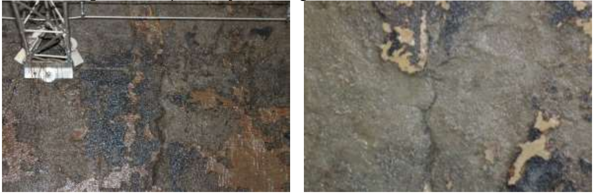
Figura 69 – Aproximações da Figura 68, evidenciando fissura.
