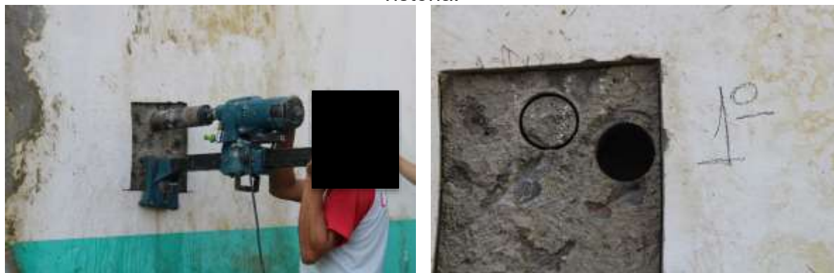
Figura 29 - Extração de testemunho de 75 mm de diâmetro na ocasião da primeira vistoria.
