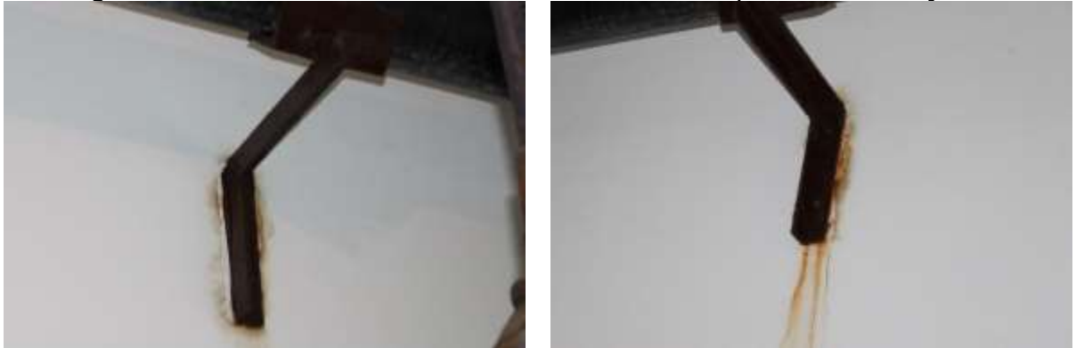
Figura 97 – Corrosão dos elementos metálicos de suporte às tubulações.
