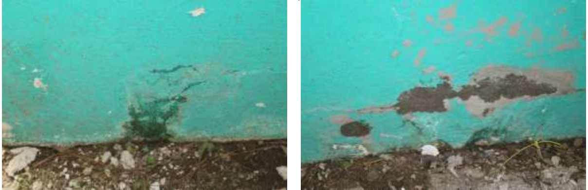
Figura 92 – Regiões com infiltrações e reparos paliativos com cimento de pega ultrarrápida.
