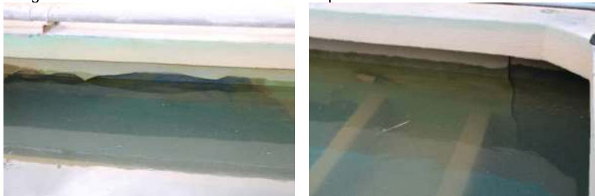
Figura 82 – Descolamento da membrana impermeabilizante no interior do filtro.
