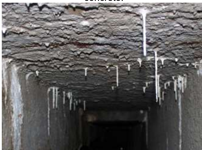
Figura 5 - Manchas esbranquiçadas e formação de estalactites devido à lixiviação do concreto.
