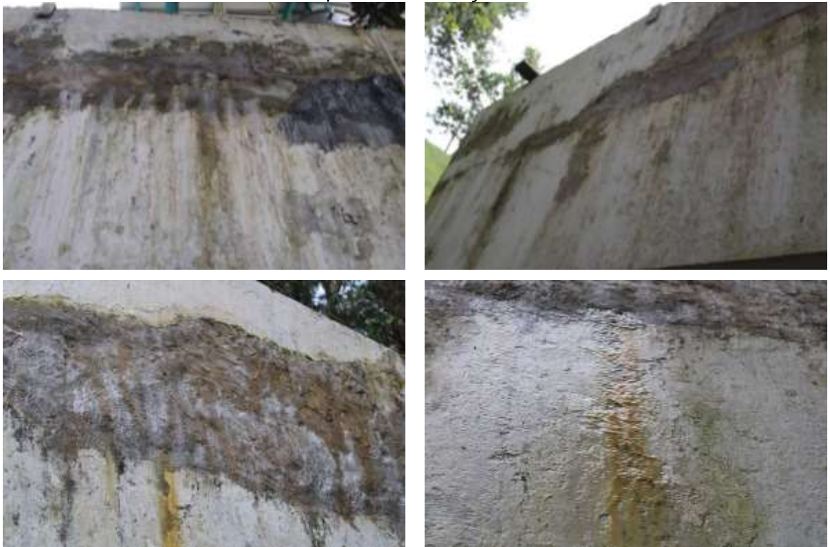
Figura 44 - Manchas esbranquiçadas (depósitos de carbonato de cálcio) devido à lixiviação do concreto por falhas na impermeabilização da canaleta. Na região foi efetuado reparo com cimento de pega ultrarrápida, porém, este foi insuficiente para impedir as infiltrações
