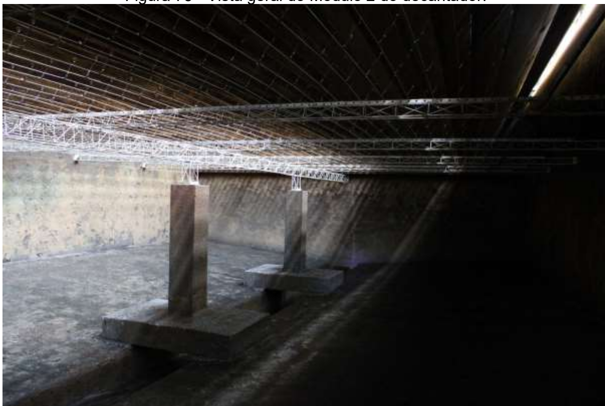
Figura 75 - Vista geral do Módulo 2 do decantador.
