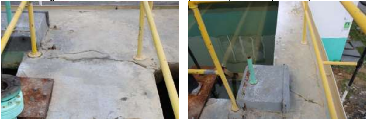
Figura 55 - Fissuras ocasionadas por esforços de tração na laje.
