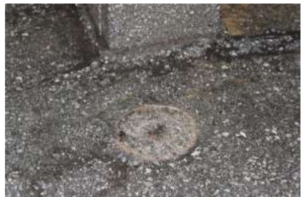
Figura 73 – Aspecto do piso com abrasão.
