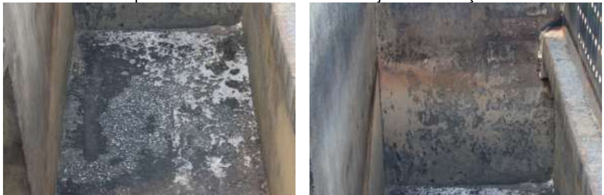
Figura 60 – Vista do fundo e da parede da região entre os flocculadores e decantadores. Nota-se a deterioração da impermeabilização, prejudicando a estanqueidade e deixando o concreto sujeito a infiltrações.
