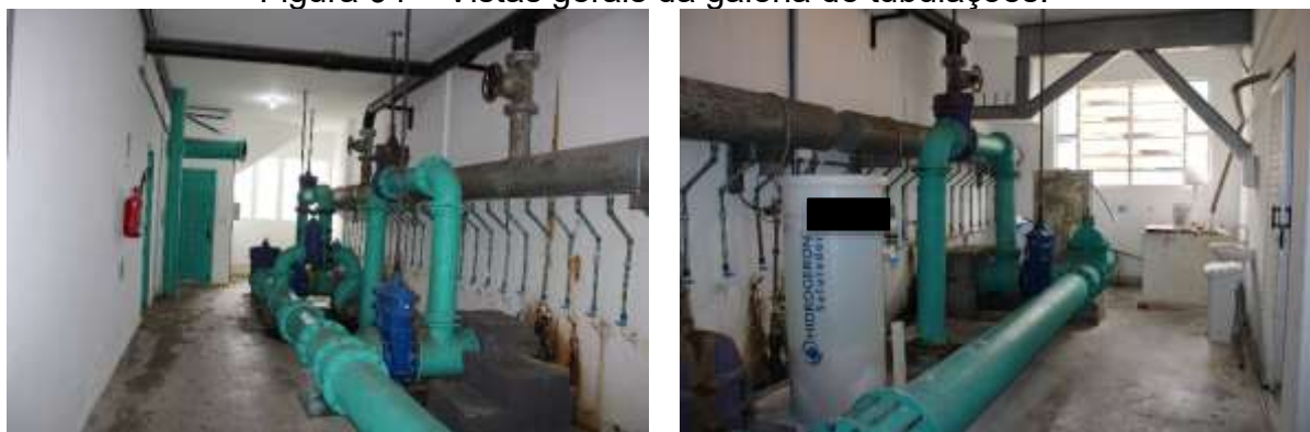
Figura 94 – Vistas gerais da galeria de tubulações.
