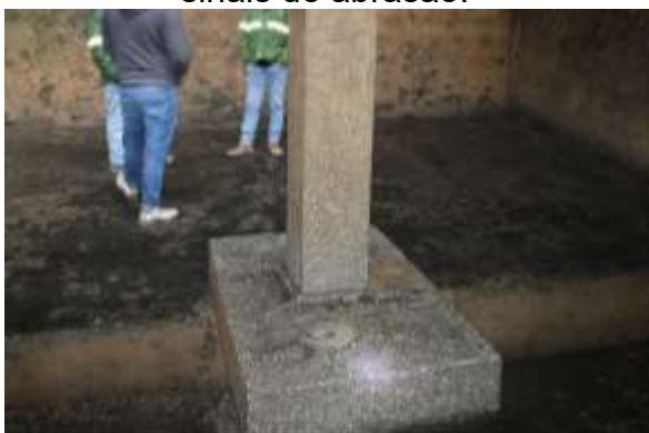
Figura 72 – Pilar executado de sustentação da cortina de difusão com sinais de abrasão.
