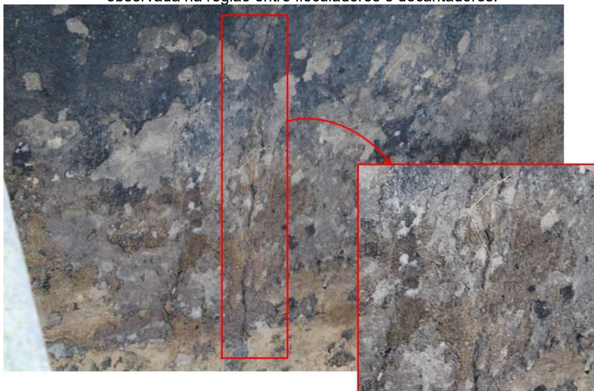
Figura 63 – Fissura de retração agravada pela incidência de água em seu interior, observada na região entre flocluladores e decantadores.
