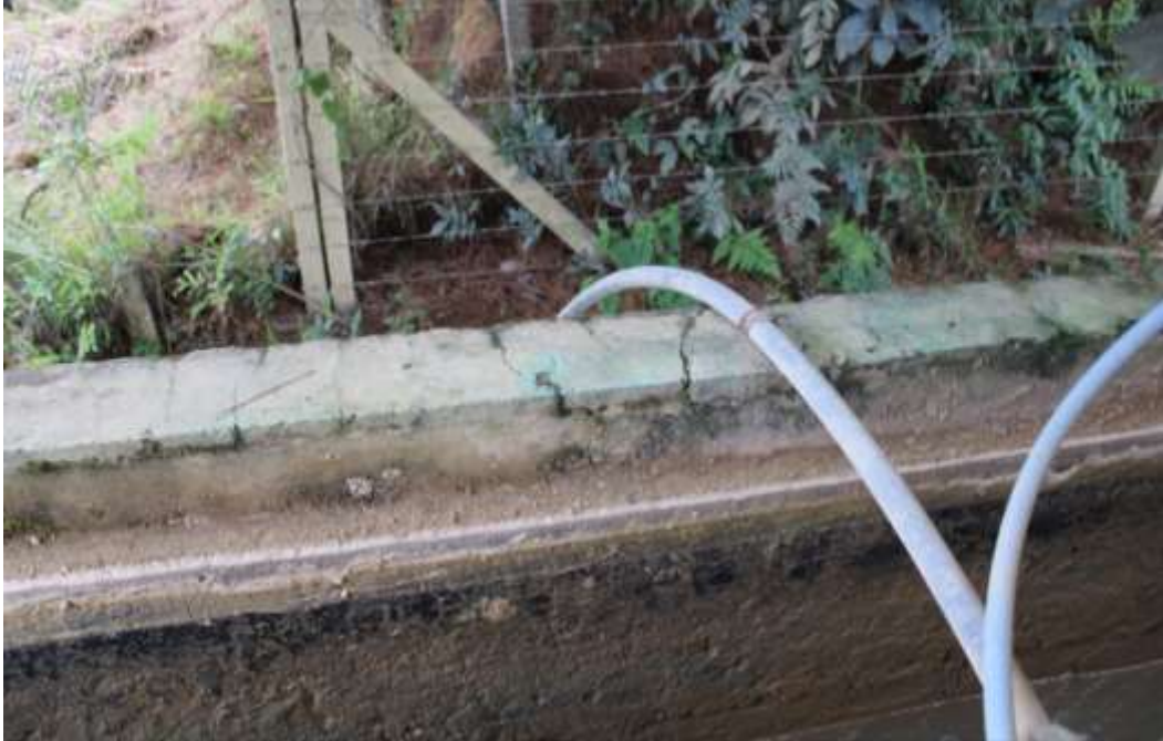
Figura 49 - Fissuras de origem higroscópica ocasionadas pela ausência de pingadeira sobre a canaleta, permitindo a retenção de água na superfície.
