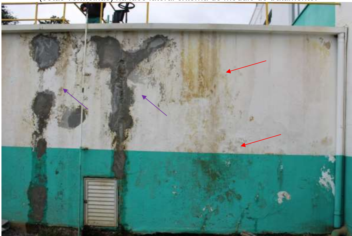
Figura 84 – Locais com infiltrações acentuadas (setas roxas), manchas de umidade (setas vermelhas) na face lateral externa do módulo de tratamento.
