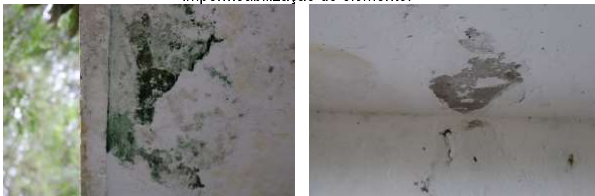
Figura 47 - Manchas de umidade e empolamento da pintura na face inferior da canaleta, nos fundos do módulo de tratamento, ocasionados por falhas na impermeabilização do elemento.
