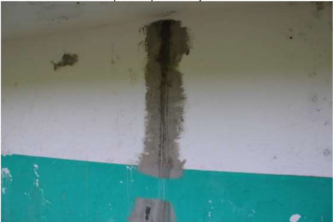
Figura 88 – Manchas esbranquiçadas (eflorescências) devido à lixiviação dos sais solúveis presentes no cimento de pega ultrarrápida utilizado como tratamento paliativo para infiltrações.
