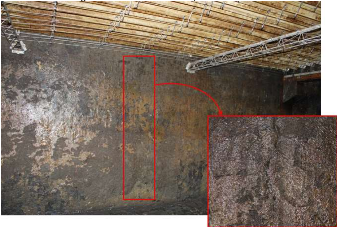
Figura 71 - Fissura de retração na Parede C.
