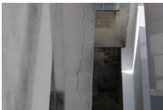
Figura 7 – Fissura devido a corrosão da armadura do concreto.
