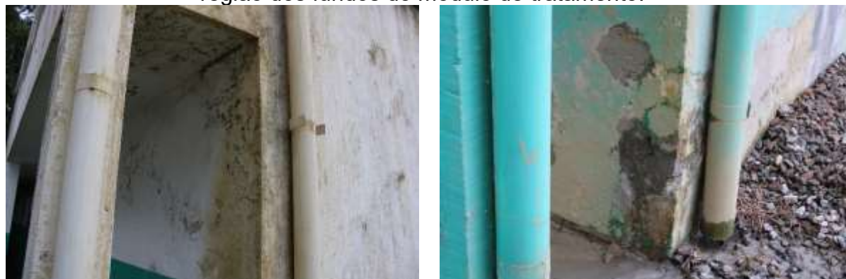
Figura 91 – Manchas de umidade e tentativa de reparação em focos de infiltração na região dos fundos do módulo de tratamento.
