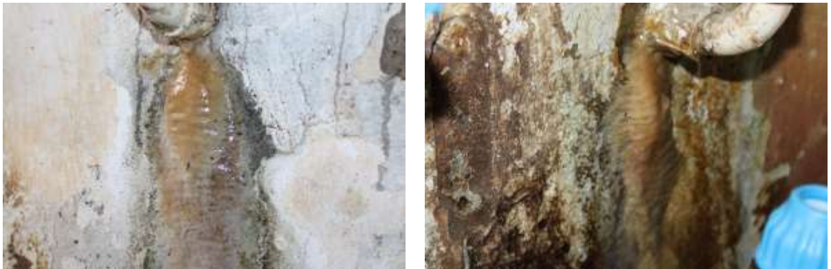
Figura 100 - Aproximações da Figura 99, evidenciando depósito de carbonato de cálcio.
