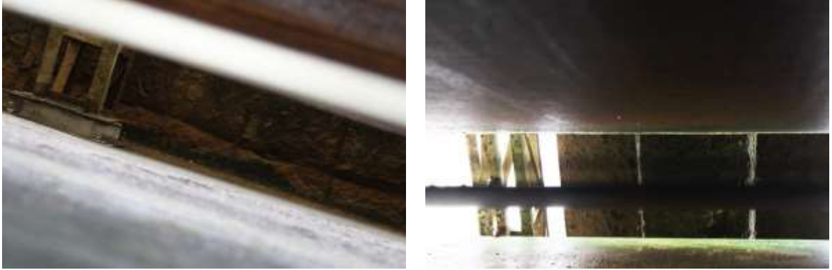
Figura 54 – Exposição e corrosão das armaduras na face inferior das passarelas.
