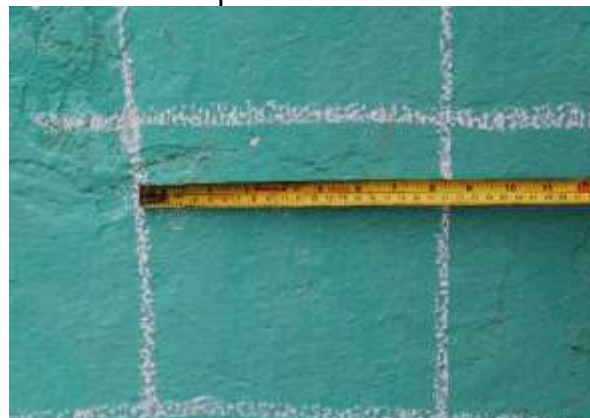
Figura 27 - Medição do afastamento das barras após mapeamento com pacômetro.
