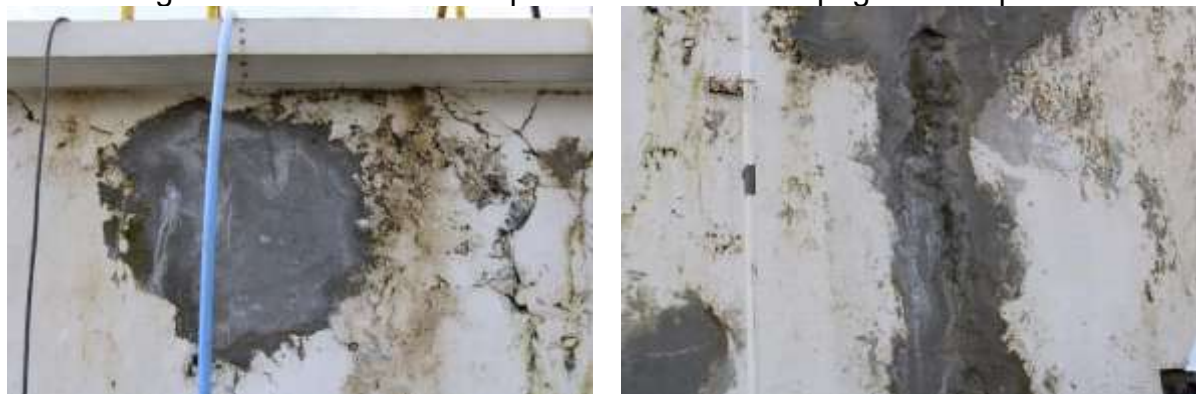
Figura 85 – Manchas brancas (eflorescências) devido à lixiviação do concreto na região onde foi efetuado reparo com cimento de pega ultrarrápida.
