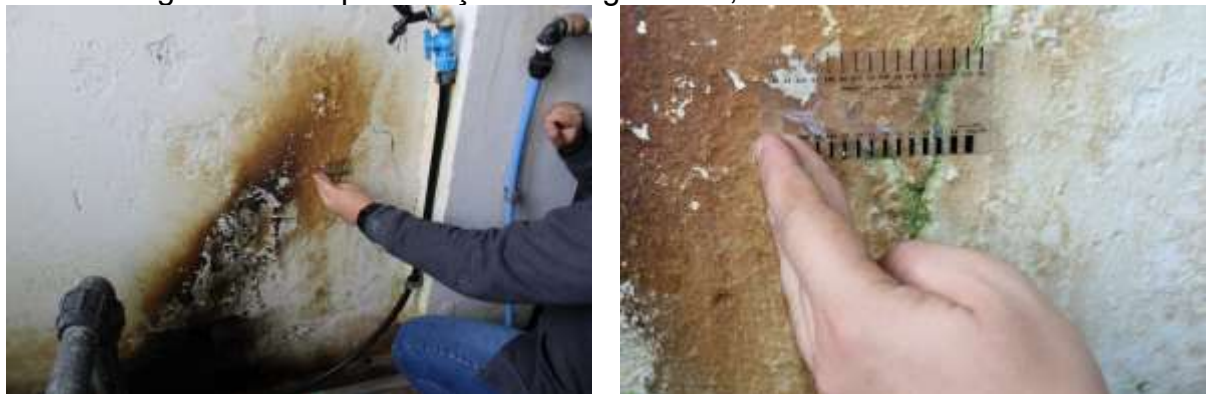
Figura 102 – Aproximações da Figura 101, evidenciando fissuras.
