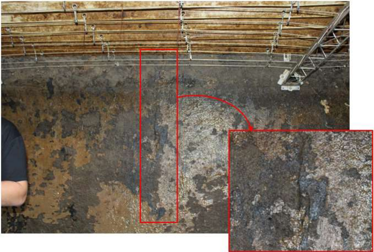
Figura 70 - Fissura de retração na Parede C.
