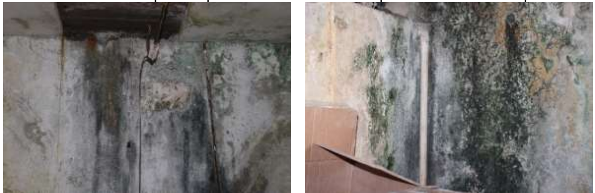
Figura 105 – Manchas de umidade, proliferação de microrganismos e empolamento e descolamento da pintura por toda a extensão das paredes e teto do depósito.
