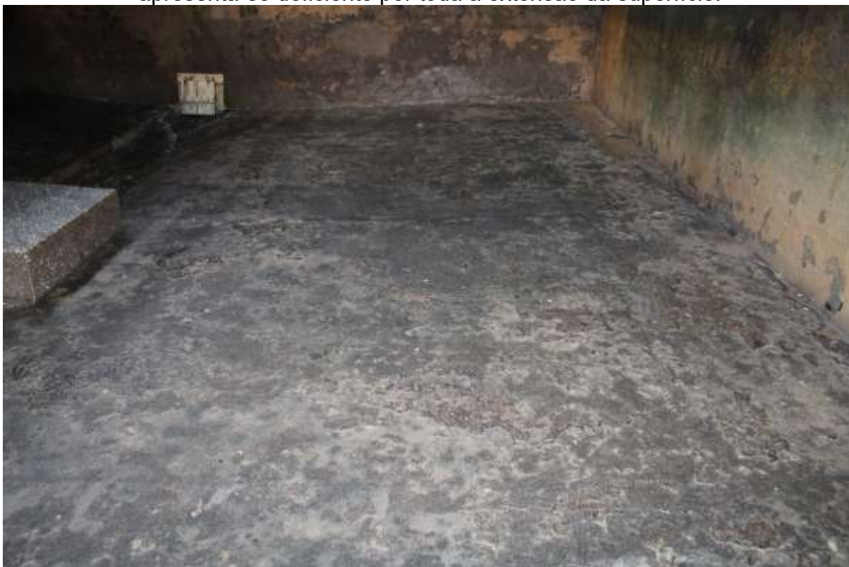
Figura 78 - Aspecto geral da impermeabilização da laje de fundo. Nota-se que esta apresenta-se deficiente por toda a extensão da superfície.
