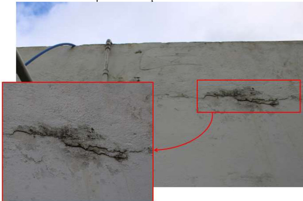
Figura 50 – Fissura de amarração devido à ampliação da canaleta de concreto. Nota-se a ocorrência de infiltrações através da mesma, devido a falhas na impermeabilização da canaleta.
