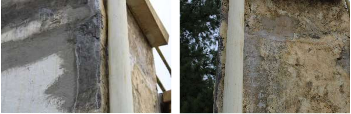
Figura 43 - Manchas esbranquiçadas (depósitos de carbonato de cálcio) devido à lixiviação do concreto.
