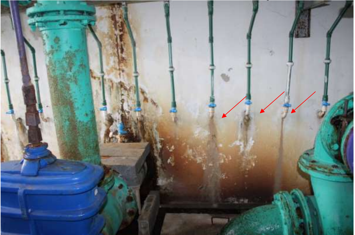
Figura 99 – Acúmulo de carbonato de cálcio devido a lixiviação do concreto.
