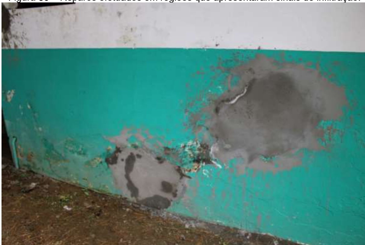
Figura 86 – Reparos efetuados em regiões que apresentaram sinais de infiltração.
