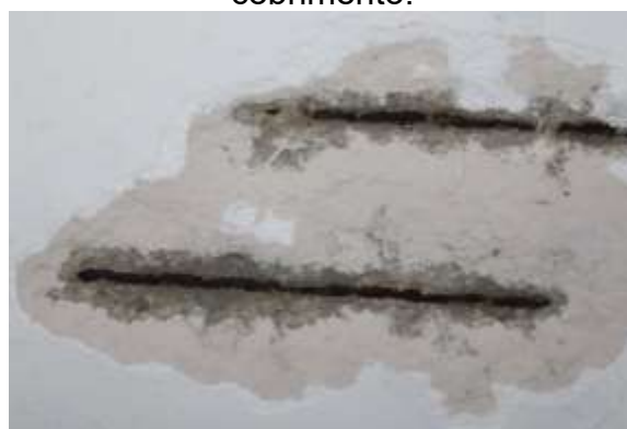
Figura 8 - Armadura exposta devido ao destacamento do concreto de cobrimento.
