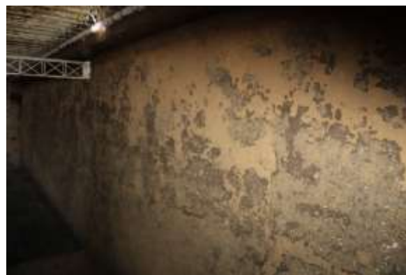
Figura 77 - Aspecto geral da impermeabilização da Parede D. Nota-se que esta apresenta-se deficiente por toda a extensão da parede.
