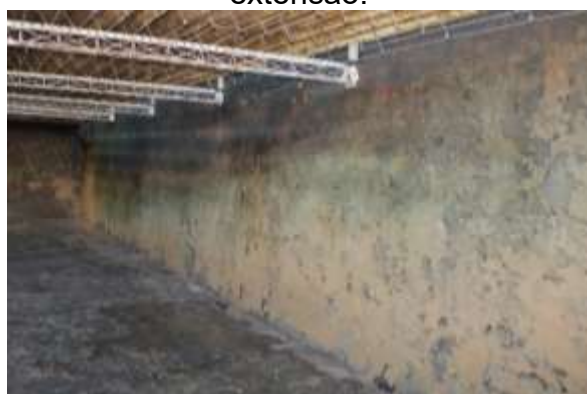
Figura 76 - Aspecto geral da impermeabilização na Parede A. Nota-se a proliferação de microrganismos e a deficiência desse sistema por toda a sua extensão.
