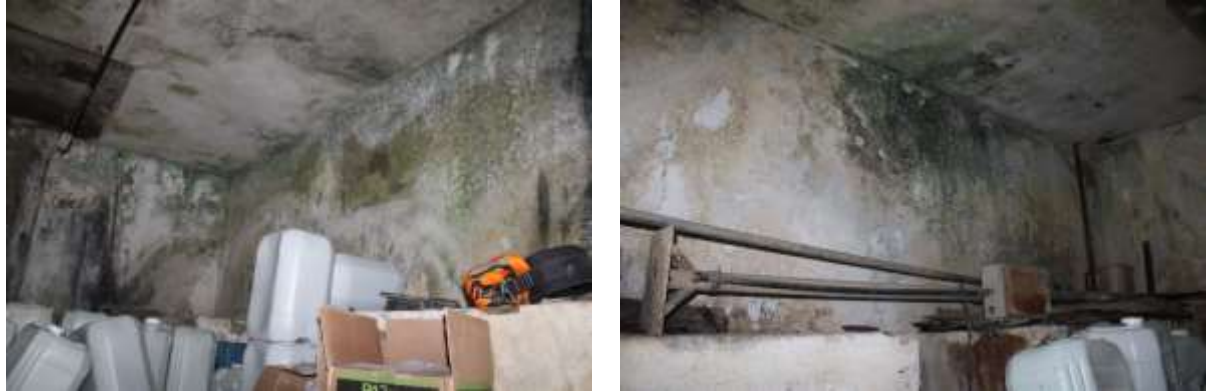
Figura 104 - Manchas de umidade, proliferação de microrganismos e empolamento e descolamento da pintura por toda a extensão das paredes e teto do depósito.
