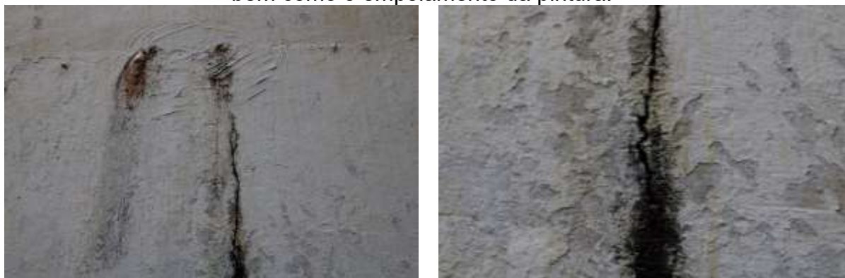
Figura 48 - Fissuras de origem higroscópica na lateral da canaleta. Devido à abertura destas fissuras, está ocorrendo também a lixiviação do concreto na região, bem como o empolamento da pintura.
