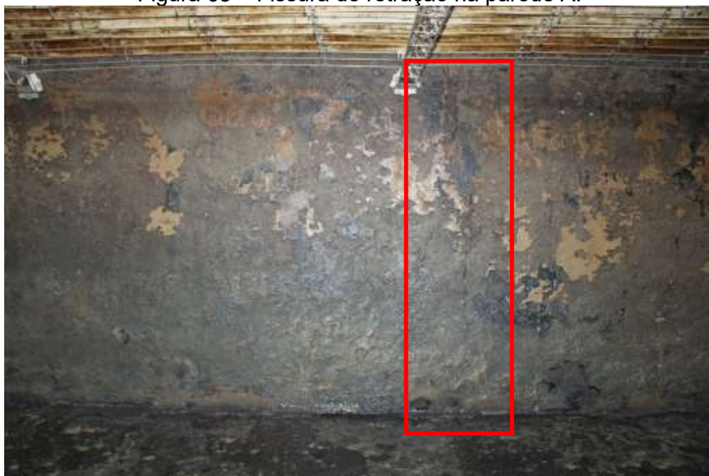
Figura 68 – Fissura de retração na parede A.
