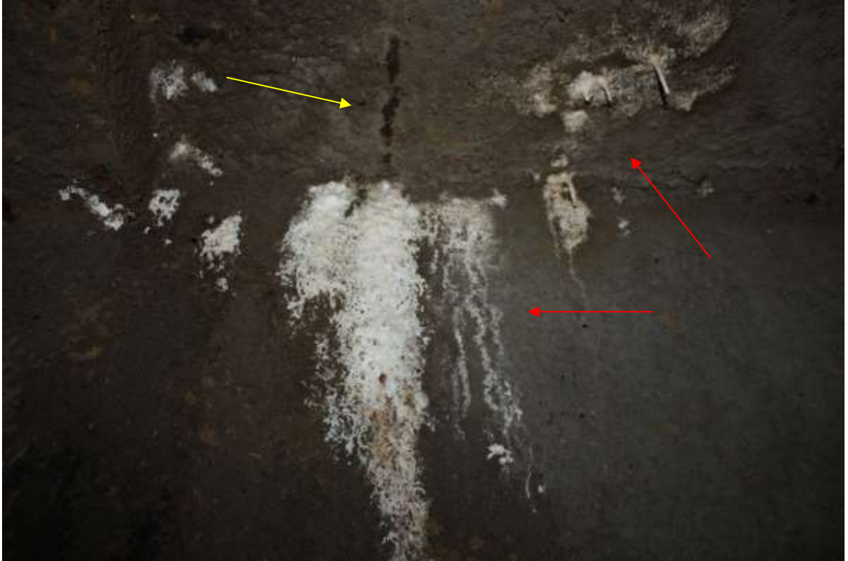
Figura 108 – Acúmulo de carbonato de cálcio na superfície devido à lixiviação do concreto (seta vermelha), e exposição e corrosão da armadura (seta amarela).
