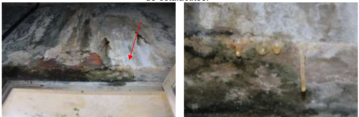
Figura 106 – Lixiviação do revestimento argamassado, evidenciado pela presença de estalactites.
