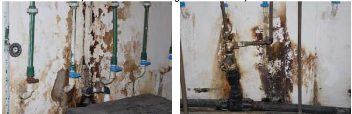
Figura 96 – Manchas de umidade e empolamento e descolamento da pintura na parede dos fundos da galeria de tubulações.
