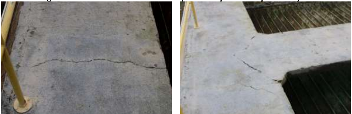
Figura 56 – Fissuras ocasionadas por esforços de tração na laje.
