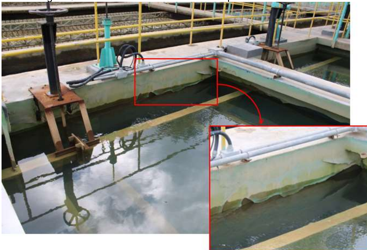
Figura 81 - Descolamento da membrana impermeabilizante do filtro.
