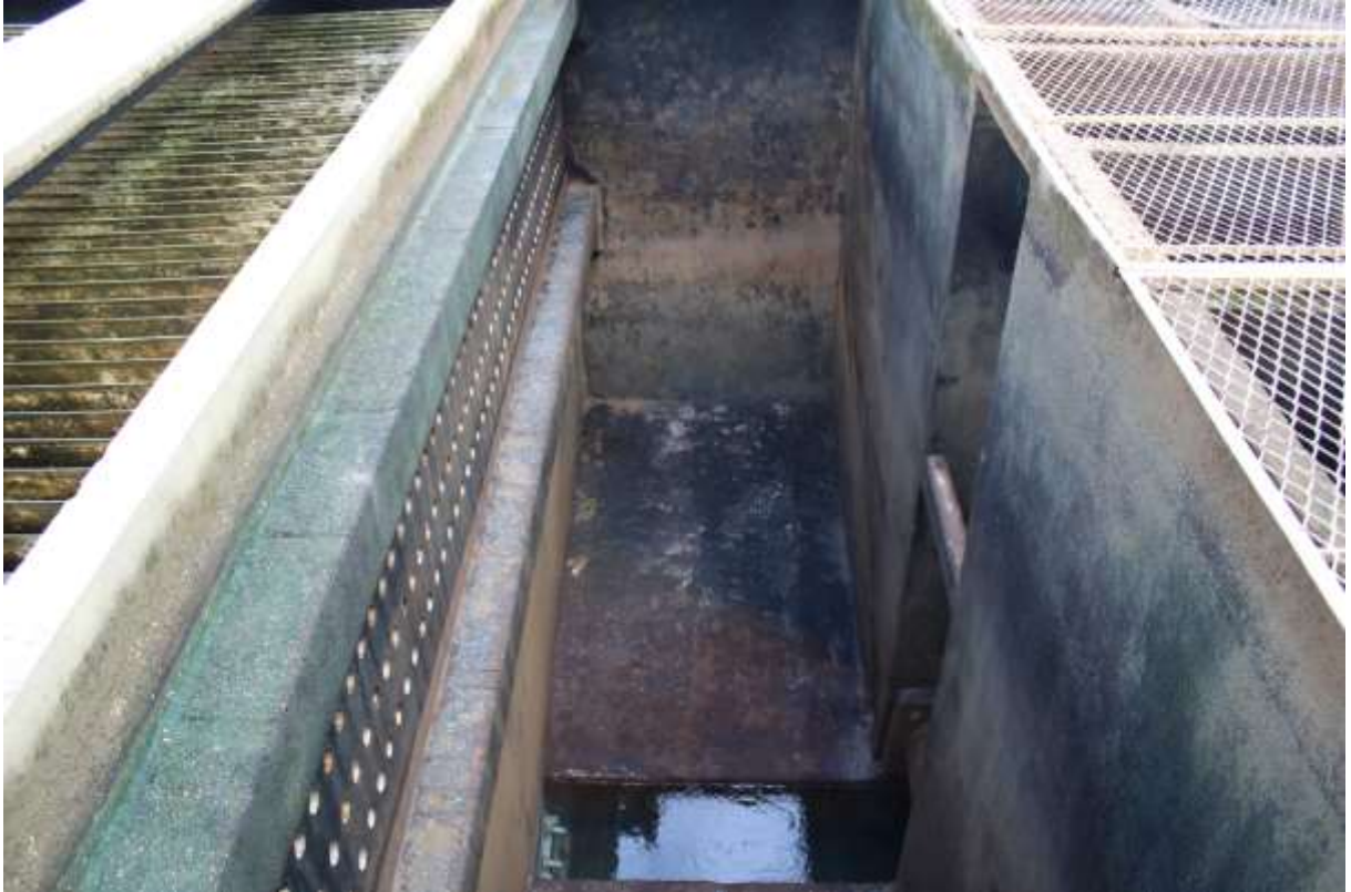
Figura 59 – Vista geral da região entre o flocculador e o decantador.
