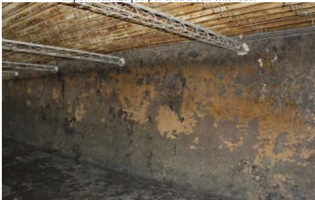
Figura 67 - Vista geral da Parede A. Nota-se a deficiência do sistema de impermeabilização por toda a sua extensão.
