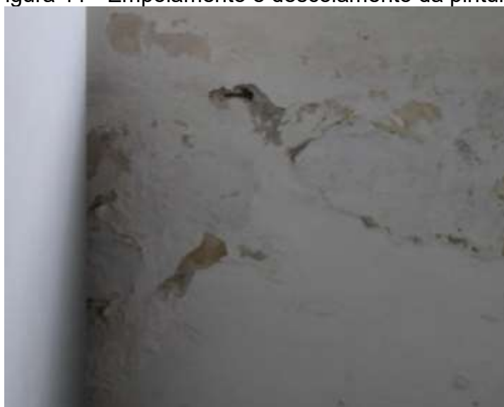
Figura 11 - Empolamento e descolamento da pintura.
