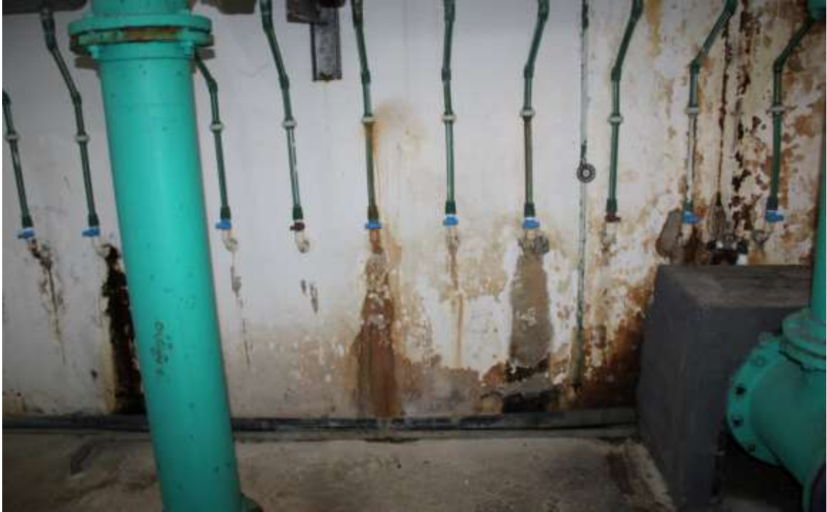
Figura 95 – Manchas de umidade e o empolamento e descolamento da pintura por toda a extensão da parede dos fundos do cômodo.
