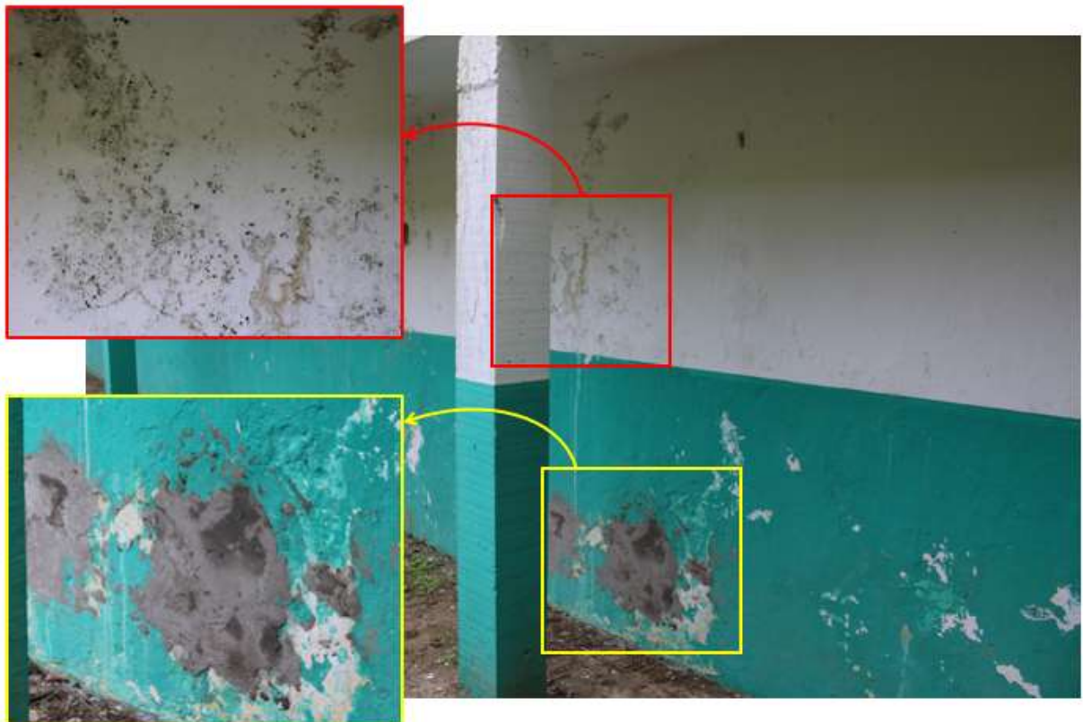
Figura 93 – Manchas de umidade (vermelho) e reparos paliativos efetuados em regiões com infiltrações (amarelo).
