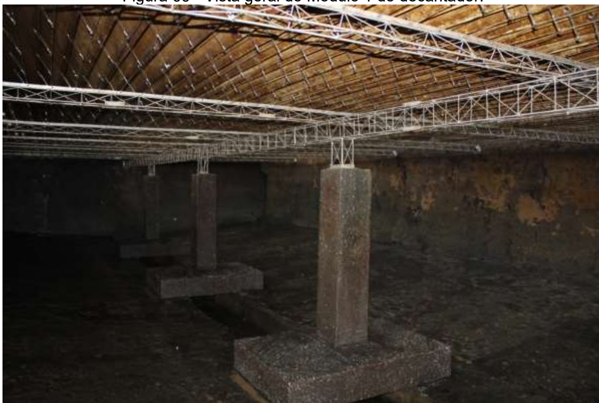
Figura 66 - Vista geral do Módulo 1 do decantador.
