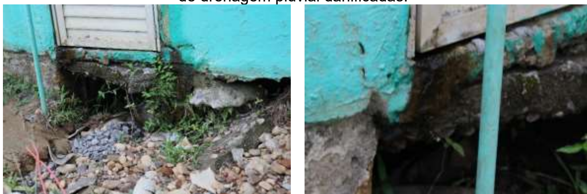
Figura 90 – Erosão do solo devido à incidência de água no local através de infiltrações na região entre filtros e decantadores e através de tubulações do sistema de drenagem pluvial danificadas.
