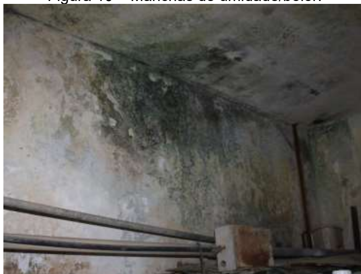
Figura 10 – Manchas de umidade/bolor.
