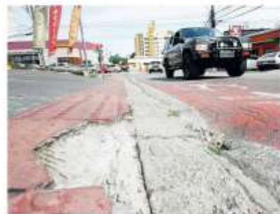
Piso tátil quebrado e ciclovia esburacada
