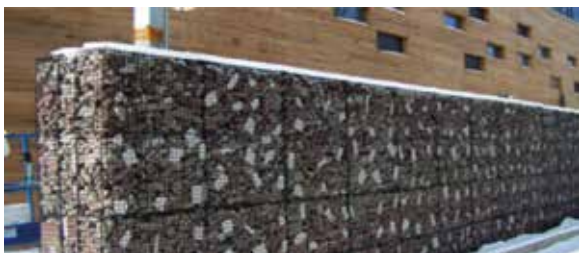
Gabião como barreira sonora Fonte: SABESP, 2010
