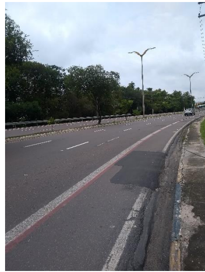
Figura 13: Trecho 2 depois da implementação do sistema. Fonte: Autor, 2021.
