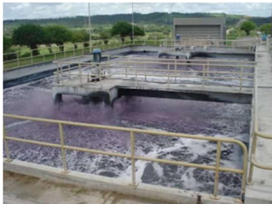
Figura 4 - Estação de tratamento de efluentes.
