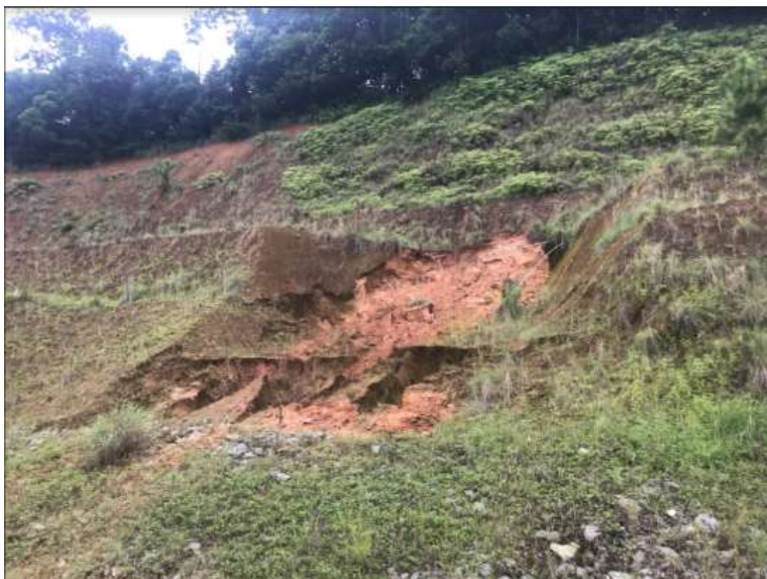
Figura 30 - Erosões e deslizamentos
