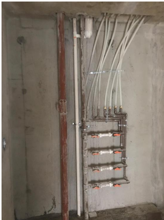
Figura 15 - Rede de kits hidráulicos instalados em obra
