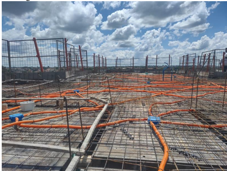
Figura 14 - Rede de kits elétricos instalados em obra
