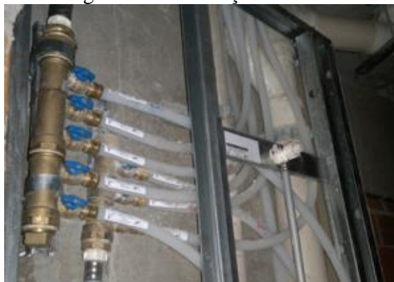
Figura 12 - Tubulação em PEX
