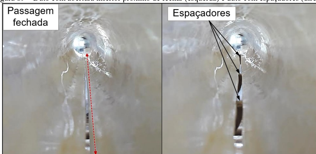
Figura 89 – Duto com abertura inferior próximo de fechar (esquerda) e duto com espaçadores (direita).
