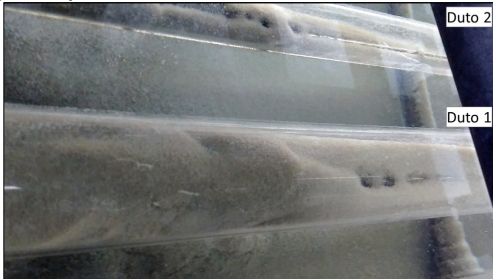
Figura 85 – Depósito de lodo nos dutos circulares, com volume considerável de lodo no fundo.
