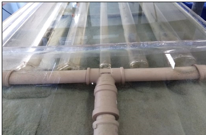
Figura 52 – Tubulação perfurada ( manifold ) para distribuição de água floculada.
