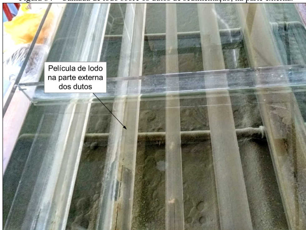
Figura 84 – Camada de lodo sobre os dutos de sedimentação, na parte externa.
