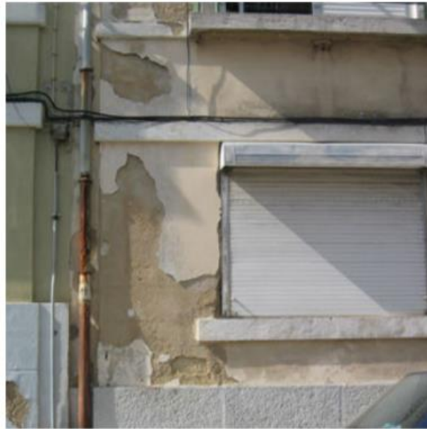
Figura 1 – Desprendimento do revestimento de argamassa
