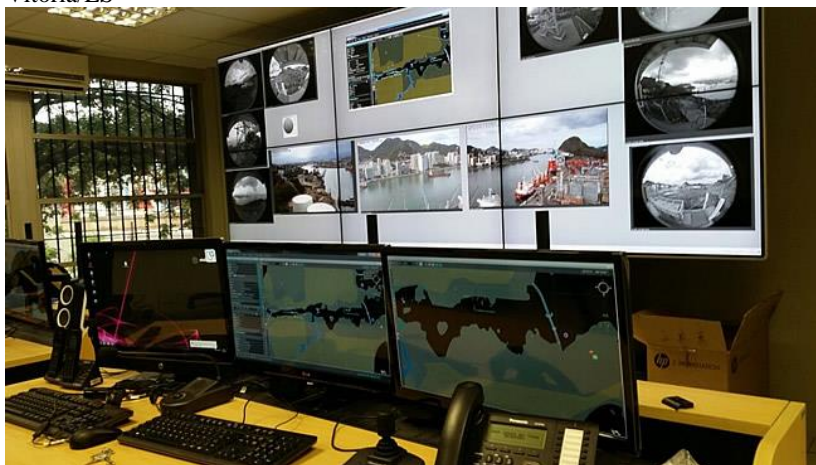
Figura 10 - Centro de Controle Operacional – CCO do VTMISS do Porto de Vitória/ES
