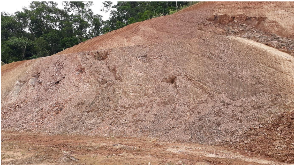
Figura 38: Ruptura planar maior ou cunha encoberta (direita) e ruptura menores em cunha (esquerda).
