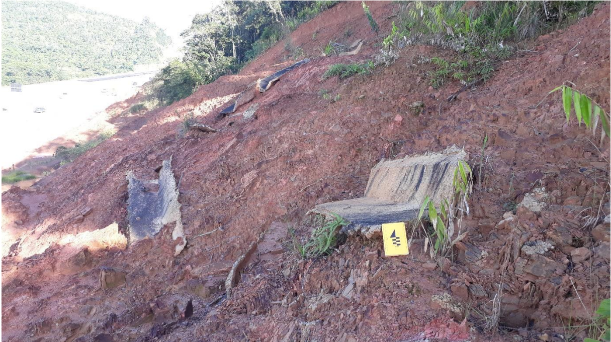
Figura 35: Sistema de drenagem danificado pelo rompimento do talude – vista para oeste.
