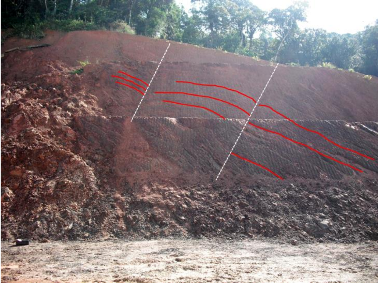
Figura 36: Dobra decamétrica de S0 no talude estudado (eixo 07-220).
