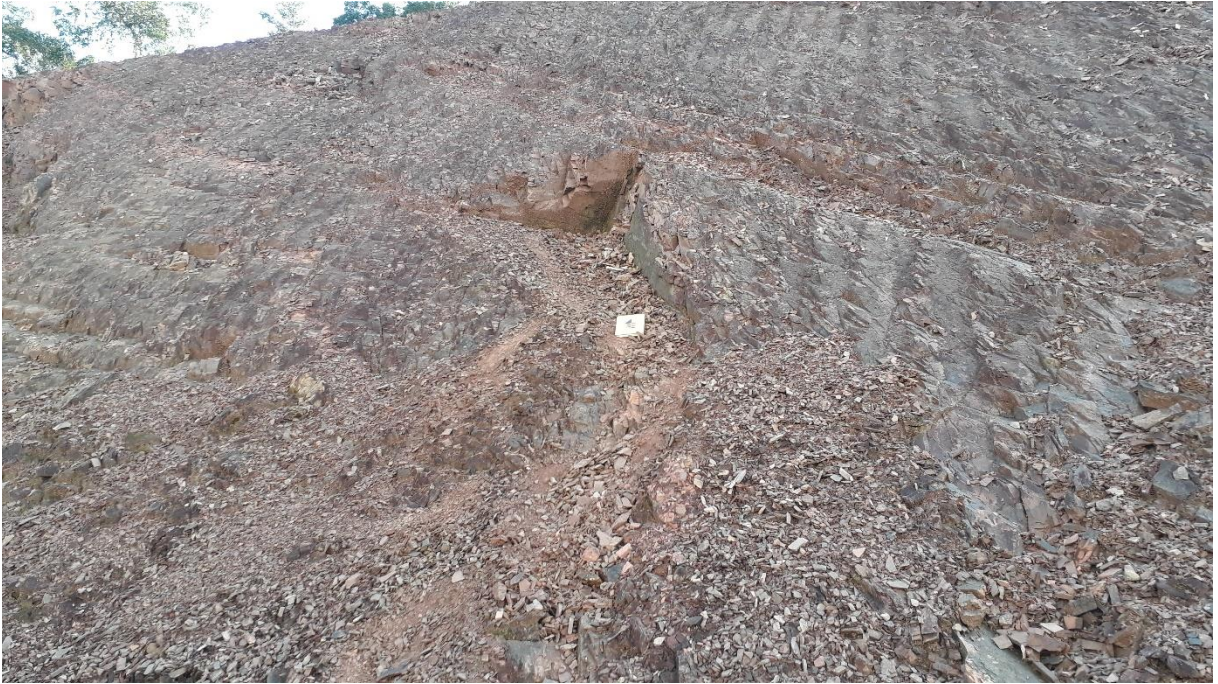
Figura 39: Detalhe de uma pequena ruptura em cunha. Caderneta de escala.
