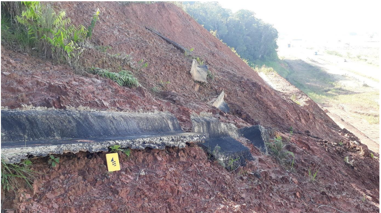
Figura 34: Sistema de drenagem danificado pelo rompimento do talude – vista para leste.
