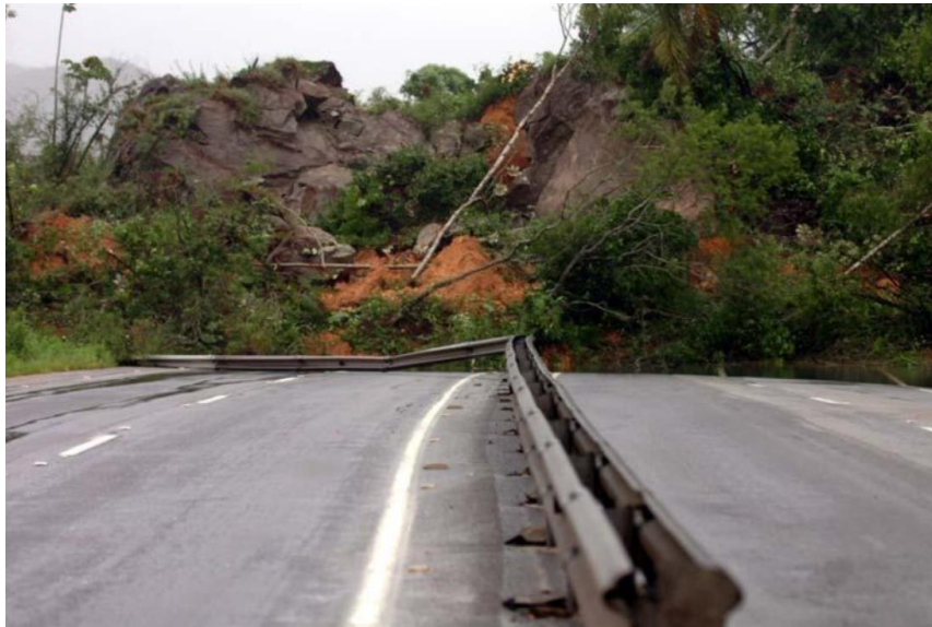
Figura 15 - Interdição da rodovia SC-401 pelo material escorregado.
