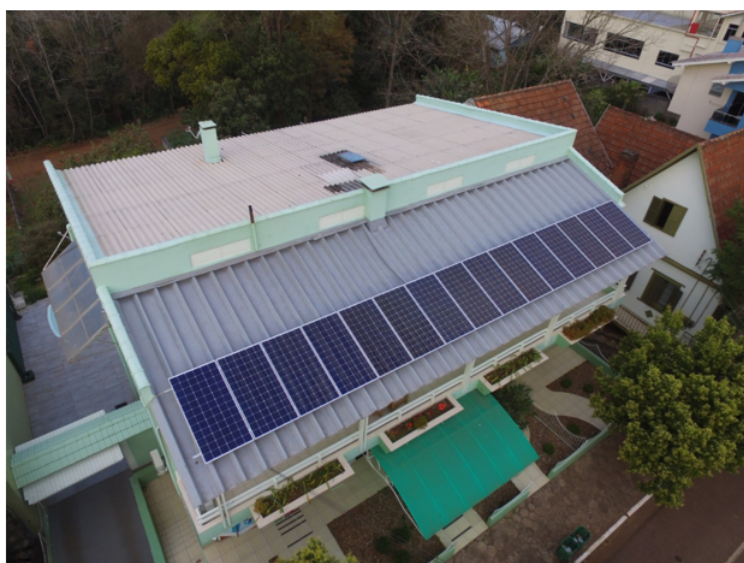
Figura 44 – Vista superior do sistema instalado. Fonte: Autor
