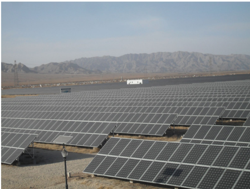
Figura 8 – Usina fotovoltaica de 100 MW na China. Fonte: [5]
