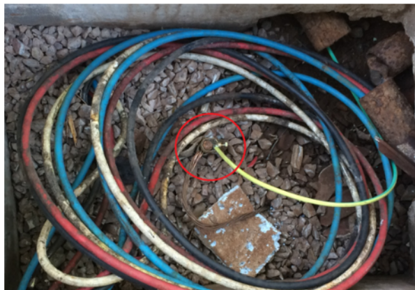
Figura 46 – Equipotencialização do sistema fotovoltaico com o aterramento presente na residência. Fonte: Autor
