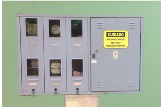
Figura 47 – Placa de sinalização no padrão de entrada alertando sobre geração própria de energia, atendendo normas da concessionária e da ANEEL. Fonte: Autor
