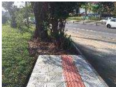
Figura 10 - Descontinuidade das calçadas existentes. SC-401.
