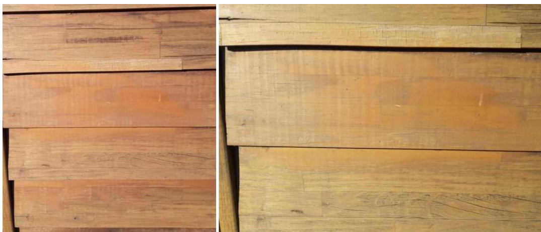
Figura 71 - Aspecto avermelhado nos sidings de madeira
