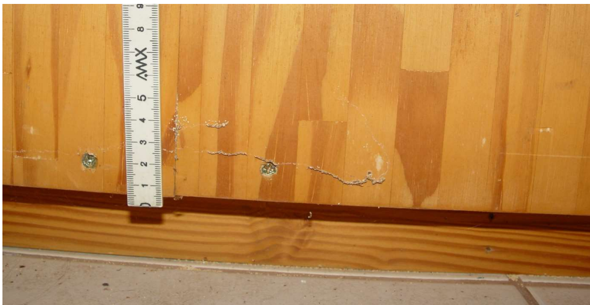
Figura 126 – Presença de canais de locomoção de cupins subterrâneos no móvel
