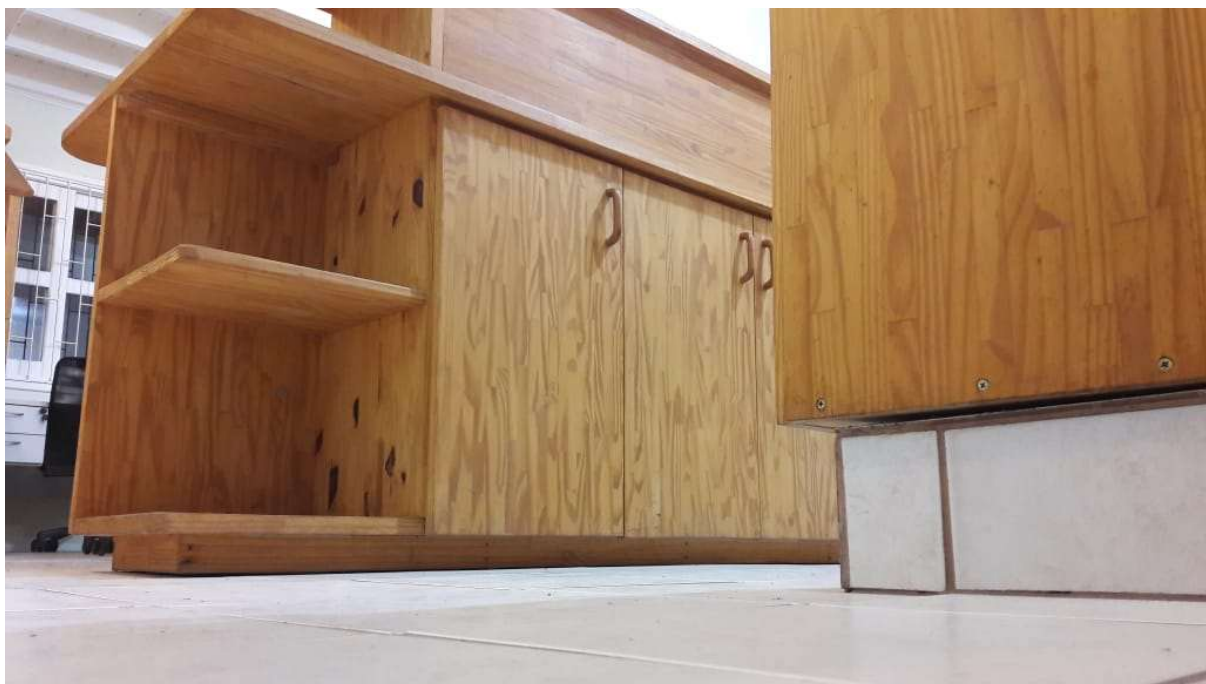
Figura 125 - Presença de patamar que separa a bancada da pia do piso
