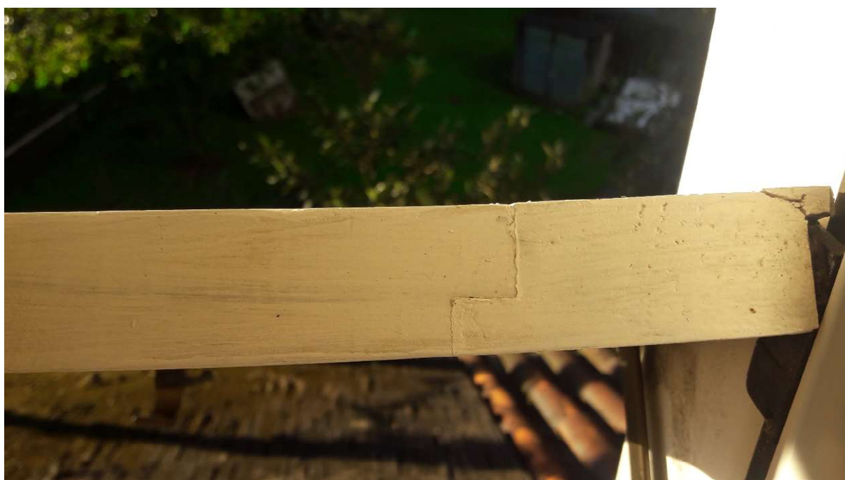
Figura 103 - Encurvamento da janela maxim-ar do ambiente quarto
