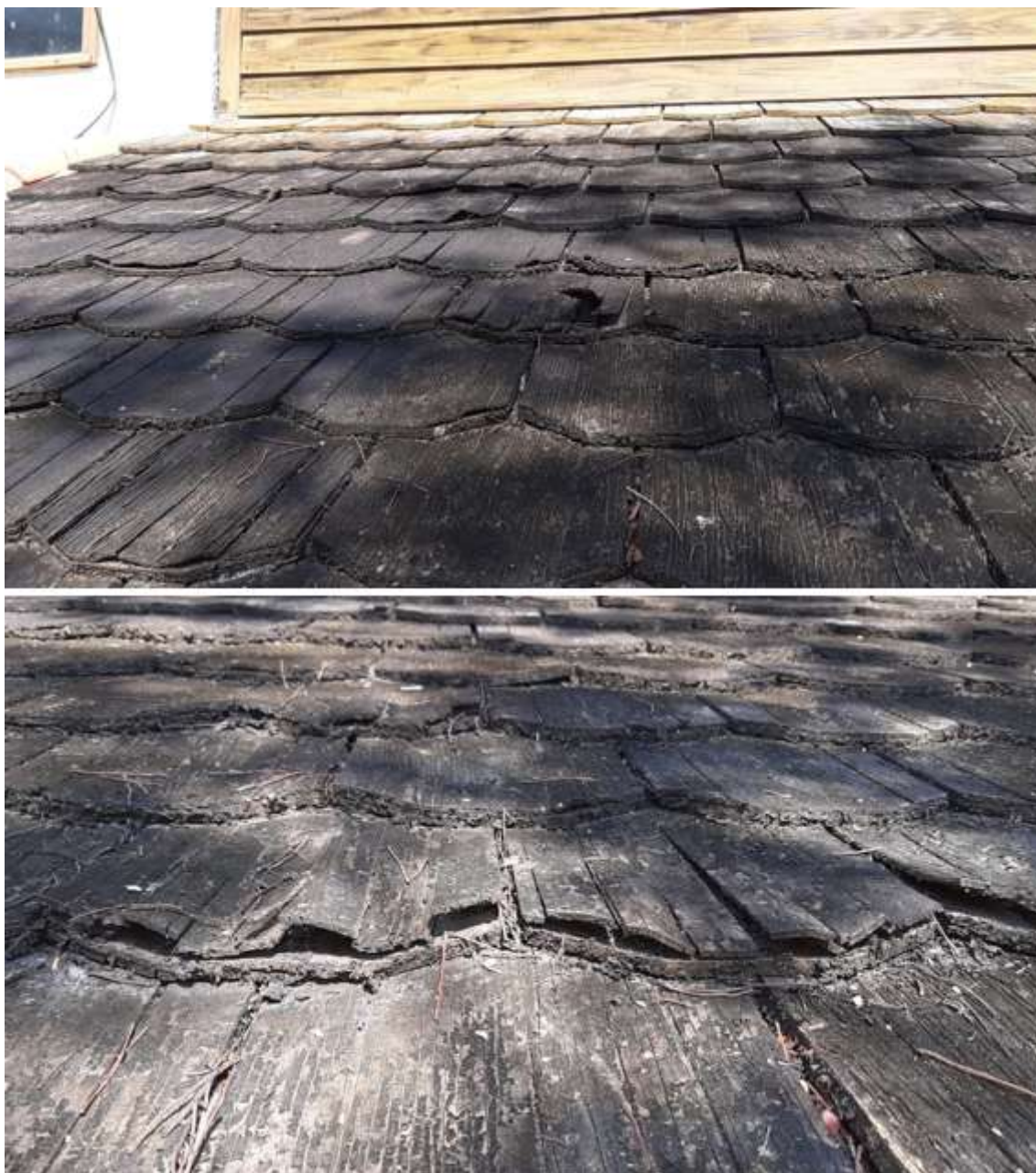
Figura 86 - Estado das telhas no protótipo por ocasião da inspeção
