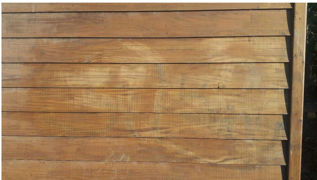
Figura 84 - Ocorrência de mancha não identificada
