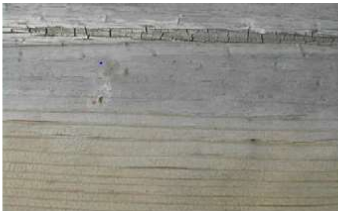
Figura 14 - Aspecto acinzentado em madeira sujeita ao intemperismo
