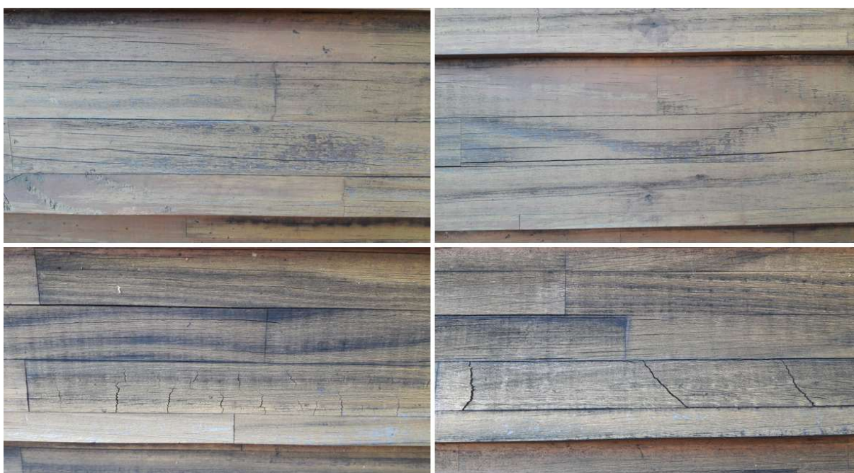
Figura 61 - Exemplos de fendas na fachada lateral
