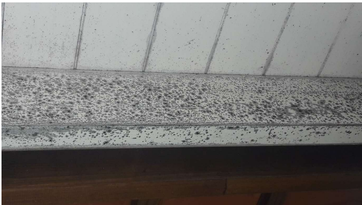
Figura 73 - Padrão de manchas nos componentes estruturais externos das fachadas frontal e traseira
