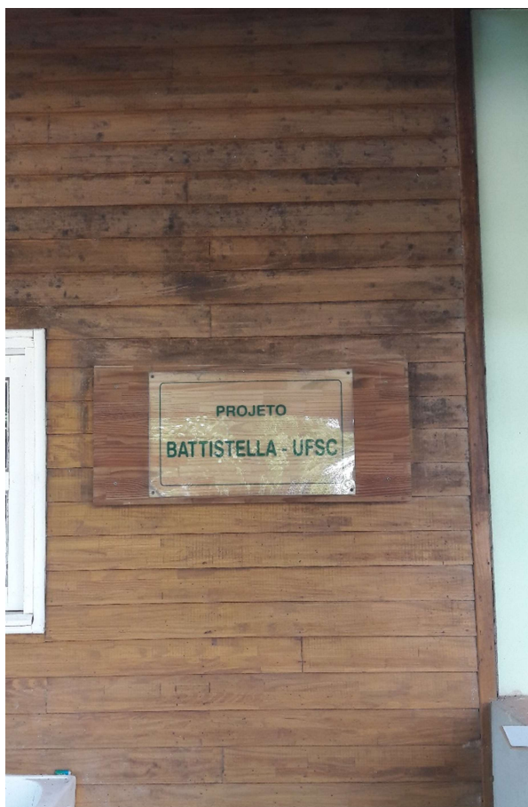
Figura 82 - Diferença do estado dos sidings na fachada traseira
