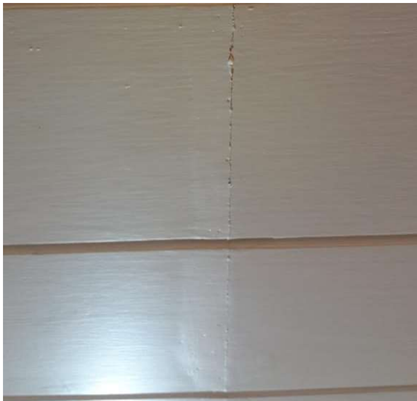
Figura 147 - Aparência de região repintada no forro de madeira
