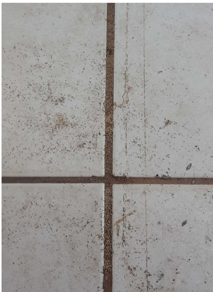
Figura 121 - Dejetos no piso abaixo do balcão
