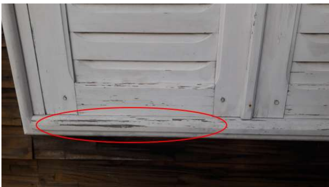
Figura 106 – Deterioração no acabamento externo da janela da fachada lateral
