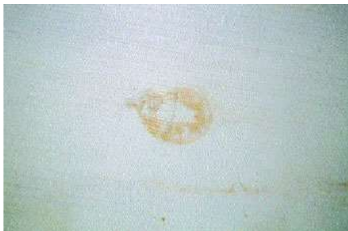
Figura 8 - Mancha em superfície pintada devida exsudação de extrativos
