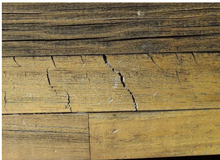
Figura 63 - Fenda transversal que necessita ser calafetada
