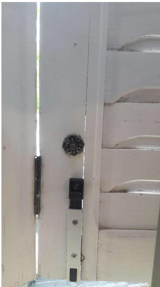
Figura 94 - Fenda longitudinal na parte sanfonada da janela
