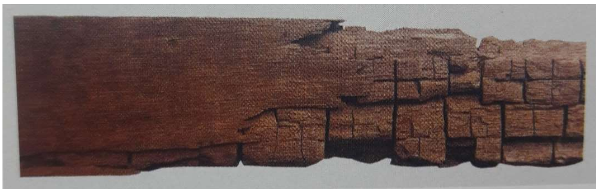
Figura 19 - Madeira com ocorrência de podridão parda
