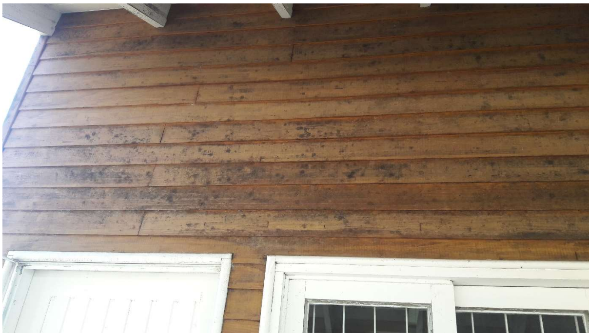
Figura 81 - Manchas nos sidings de madeira na fachada traseira sob a cobertura
