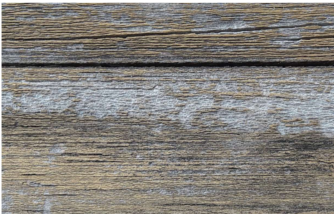
Figura 68 - Detalhe do aspecto acinzentado
