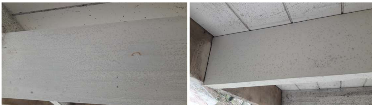
Figura 76 - Superfície das vigas analisadas após a limpeza das manchas
