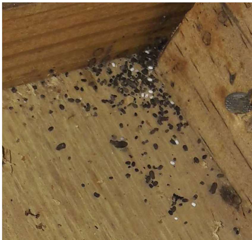
Figura 133 - Resíduo com aspecto granular
