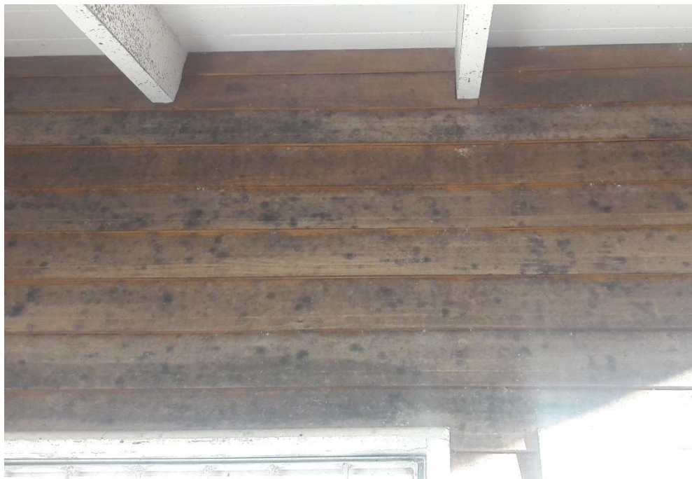
Figura 80 - Manchas nos sidings de madeira na fachada frontal sob a cobertura
