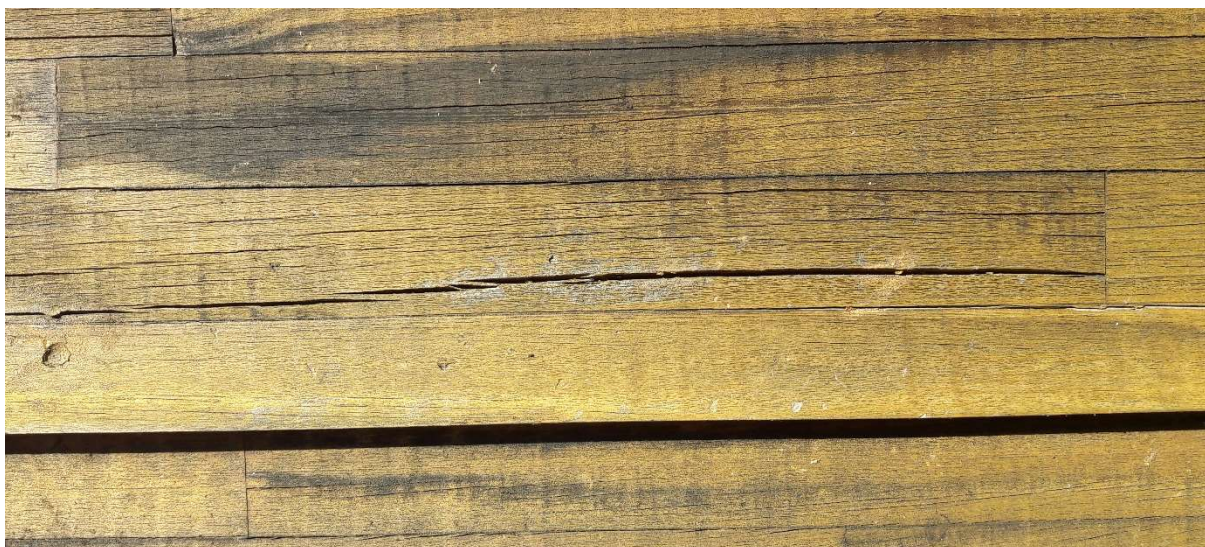
Figura 64 - Fenda longitudinal que necessita ser calafetada
