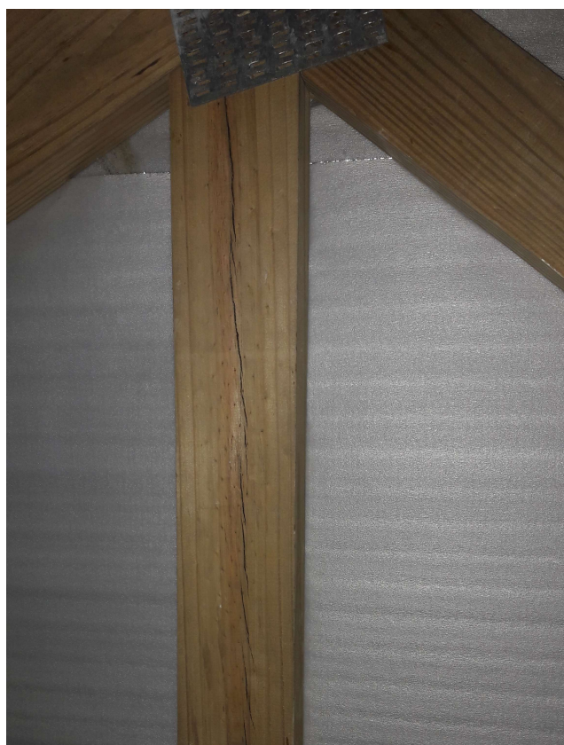
Figura 137 - Fenda longitudinal em montante vertical de treliça
