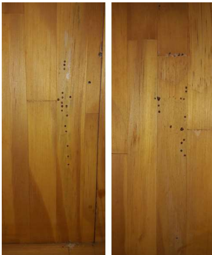
Figura 116 - Furos detectados no interior do balcão
