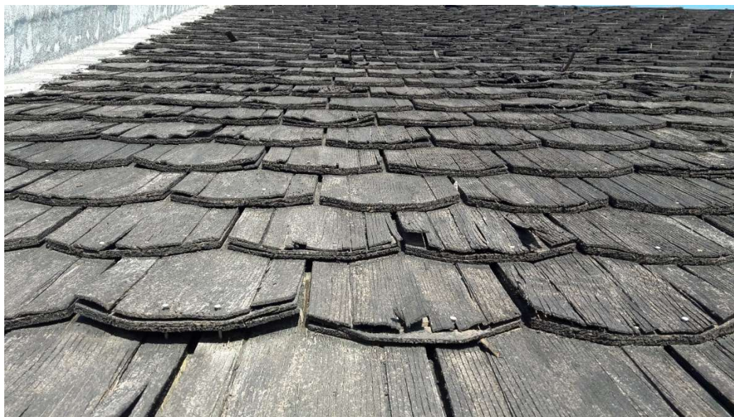
Figura 88 - Estado das telhas no telhado principal
