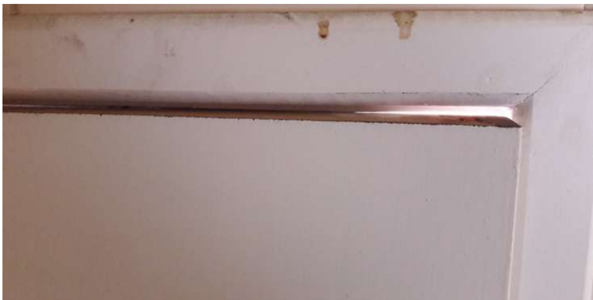
Figura 99 - Local de travamento entre a porta e a forra
