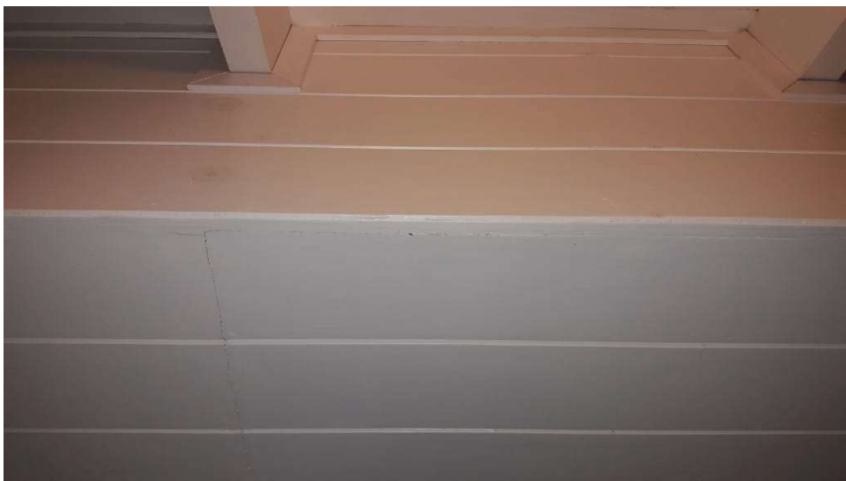
Figura 146 - Fissuras no forro do pavimento superior
