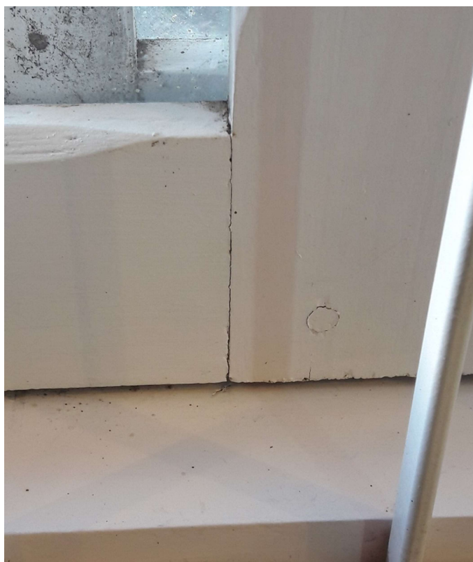
Figura 92 – Abertura da junta entre peças de madeira na janela da fachada frontal do pavimento térreo
