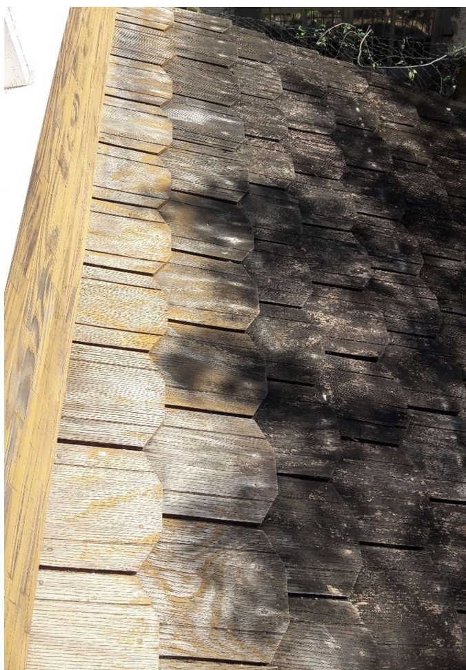
Figura 87 - Diferença de estado das telhas na fachada frontal
