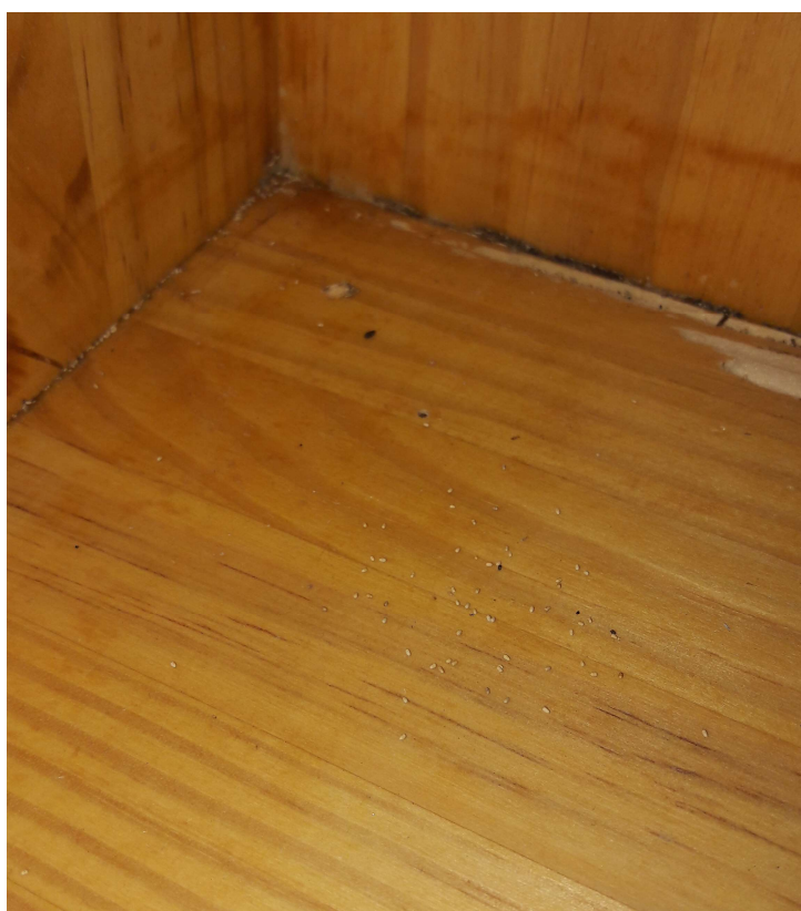
Figura 117 - Dejetos no interior do móvel
