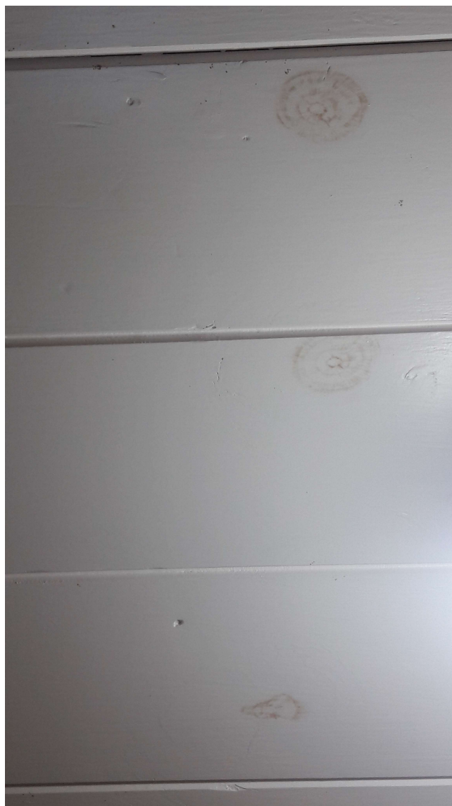
Figura 142 - Manchas amarronzadas no forro do pavimento térreo
