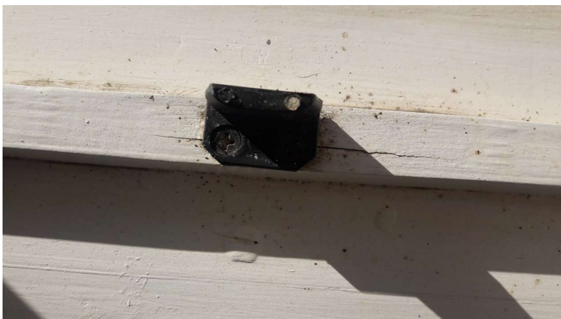
Figura 96 - Fenda localizada no puxador da janela
