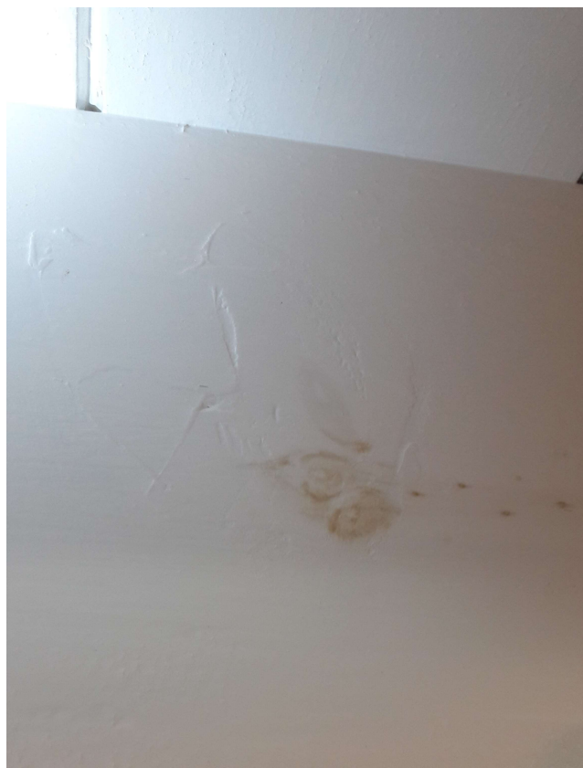
Figura 143 - Manchas amarronzadas em viga do entrepiso
