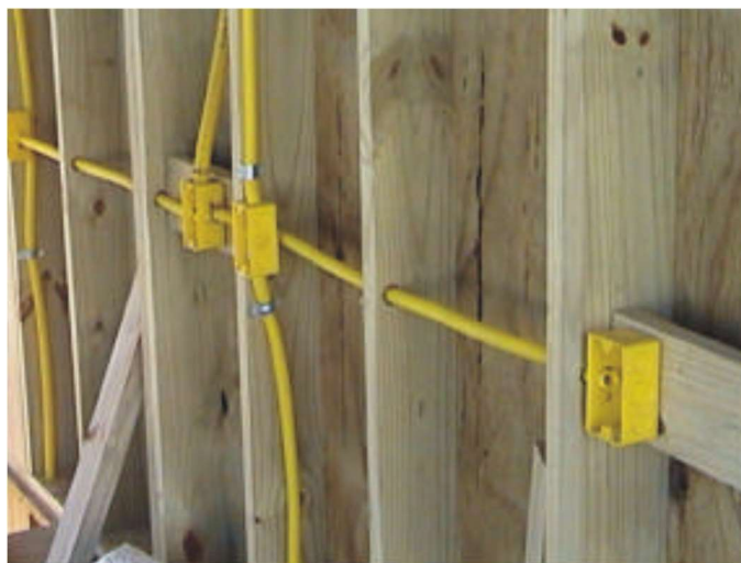
Figura 50 - Passagem de eletrodutos pelos montantes
