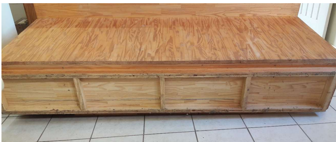
Figura 123 - Locais deteriorados na parte debaixo do balcão
