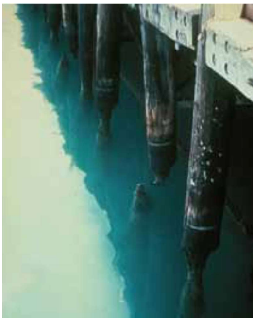
Figura 29 - Danos de Limnoria a estacas de madeira
