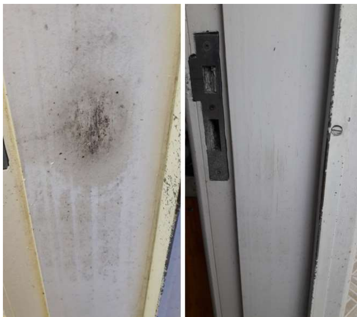
Figura 111 - Mancha na fechadura de baixo da porta, antes e depois de limpeza e lixagem
