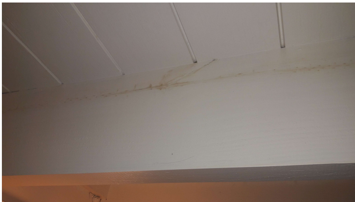
Figura 145 - Mancha longitudinal em viga do entrepiso, próxima à escada
