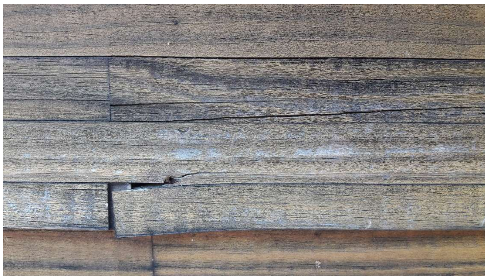
Figura 65 - Desprendimento de ripa da peça de siding
