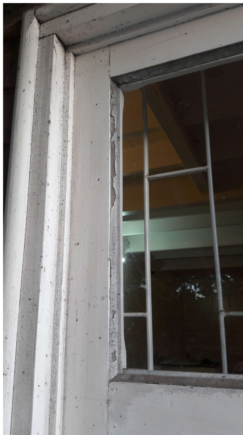
Figura 104 - Aspecto do acabamento externo na janela da varanda
