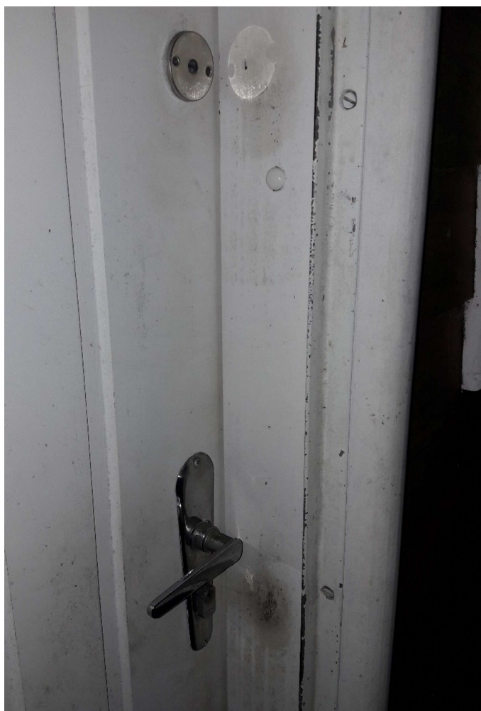
Figura 110 - Manchas de coloração bastante escurecida na forra da porta da fachada traseira
