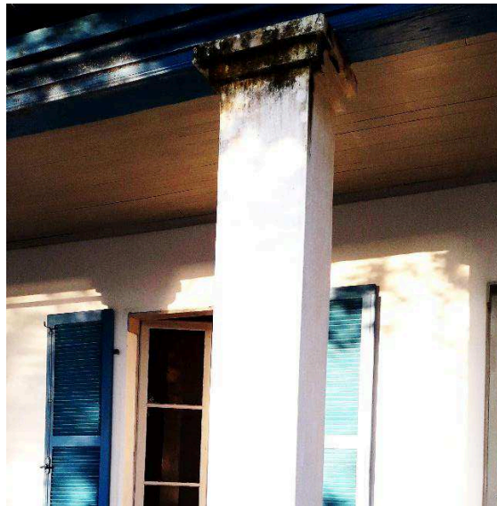
Figura 49 - Manifestação de bolor no 2º pavimento
