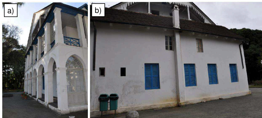
Figura 5 - Manchas de umidade ascendente no MNIC em 2014: (a) na fachada Norte; (b) na fachada Sul.
