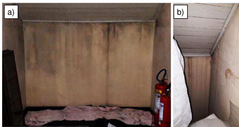
Figura 48 - Manchas de umidade descendente no 2º pavimento: (a) ponto D10; (b) ponto D11
