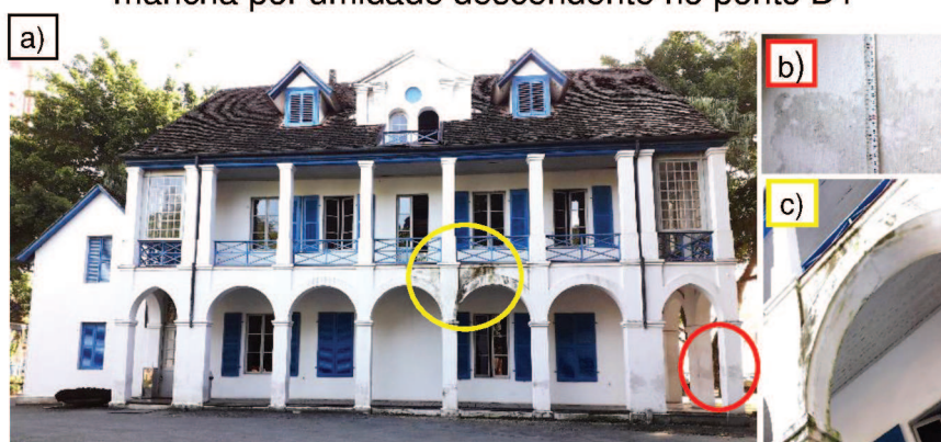
Figura 32 - Fachada Leste: (a) manifestações patológicas na fachada; (b) medição da mancha causada por umidade ascendente no ponto A10; (c) mancha por umidade descendente no ponto D1
