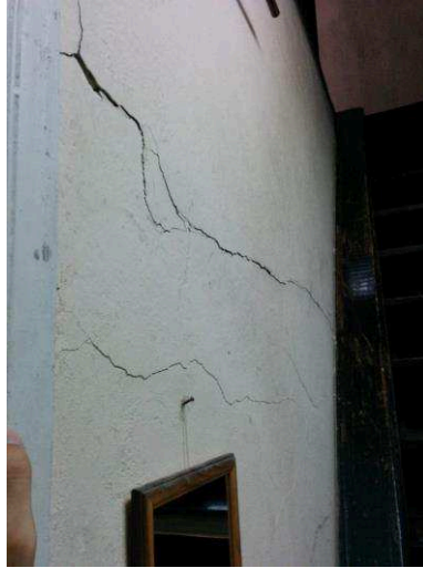
Figura 7 - Fissuras encontradas no Hall 2 do museu em 2014
