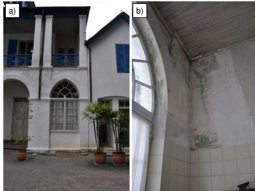
Figura 6 - Manchas de umidade devido a vazamentos encontrados no MNIC em 2014: (a) na fachada oeste; (b) no feminino no térreo.
