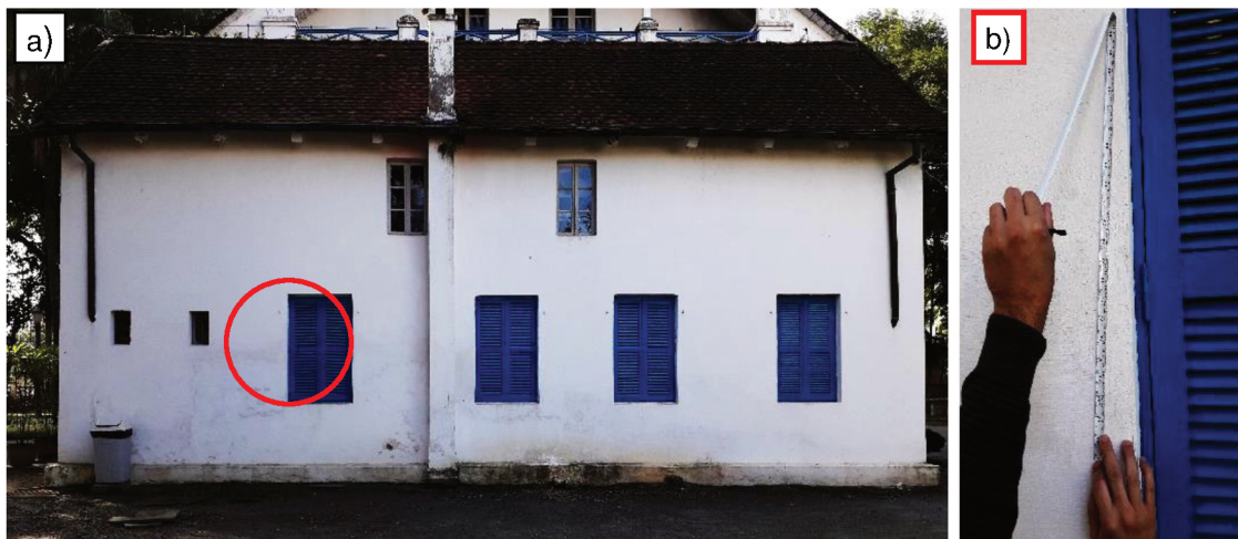
Figura 30 - Fachada Sul: (a) manifestação patológica na fachada; (b) medição da altura da mancha de umidade no ponto A1
