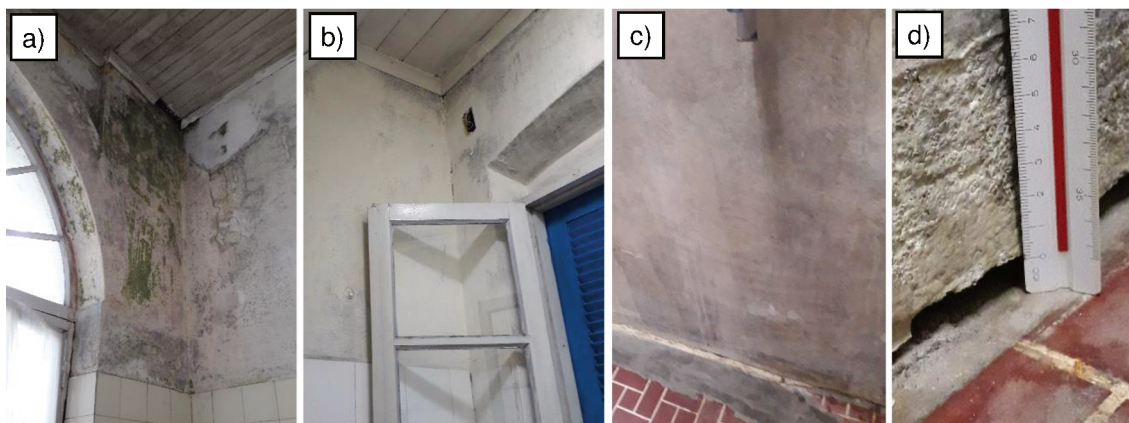
Figura 39 - Umidade no interior da edificação: (a) presença de bolor no ponto B4; (b) mancha de umidade no ponto D8; (c) mancha de umidade no ponto A24; (d) medição do descolamento entre piso e parede
