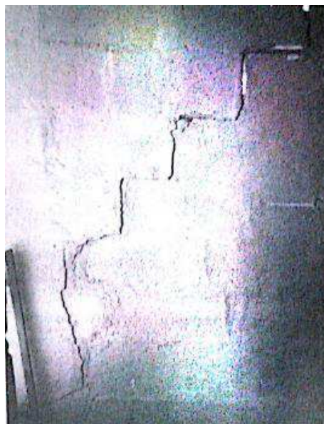
Figura 20 - Vista interna de uma parede com aberturas significativas decorrentes de recalques
