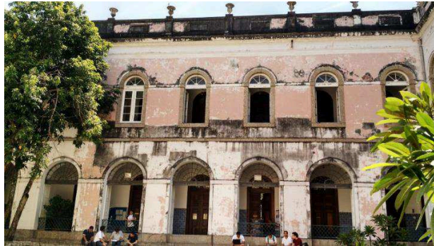
Figura 10 - Uma das fachadas dos pátios do Palácio Universitário da UFRJ, com sinais claros de umidade de precipitação
