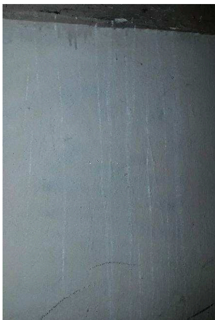
Figura 54 - Ponto E1: eflorescência encontrada no terceiro pavimento.
