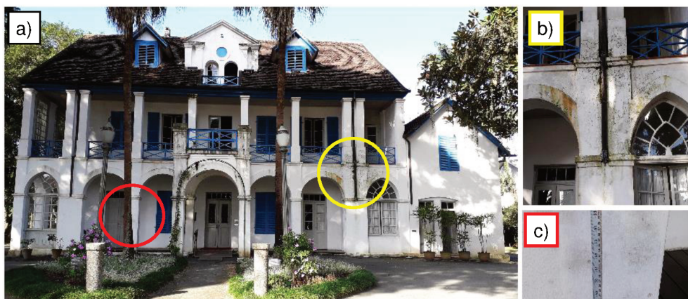
Figura 37 - Fachada Frontal: (a) manifestações patológicas na fachada; (b) degradação devido a umidade descendente no ponto D7; (c) medição da umidade ascendente no ponto A19
