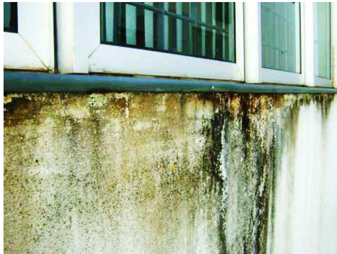
Figura 13 - Formação de bolor devido às deficiências do peitoril da janela.
