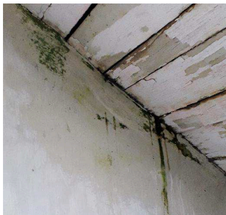
Figura 53 - Ponto B6: bolor encontrado no terceiro pavimento
