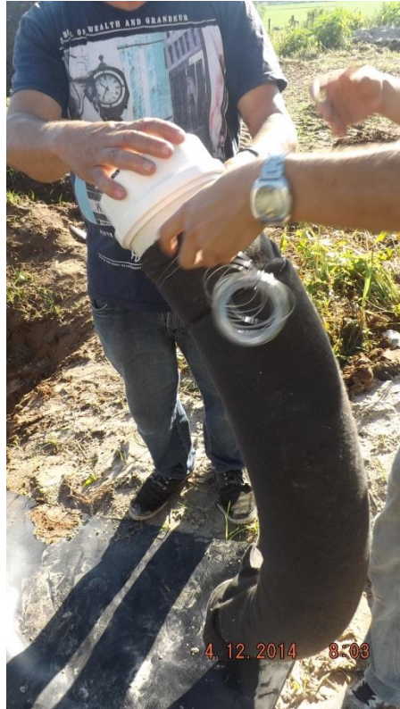
Ilustração 12: Tubo de drenagem revestido com geotêxtil
