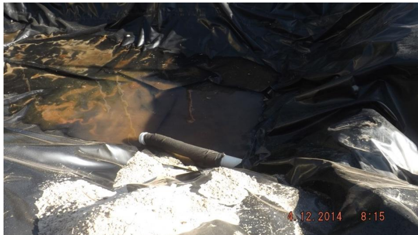
Ilustração 13: Tubo de drenagem conectado
