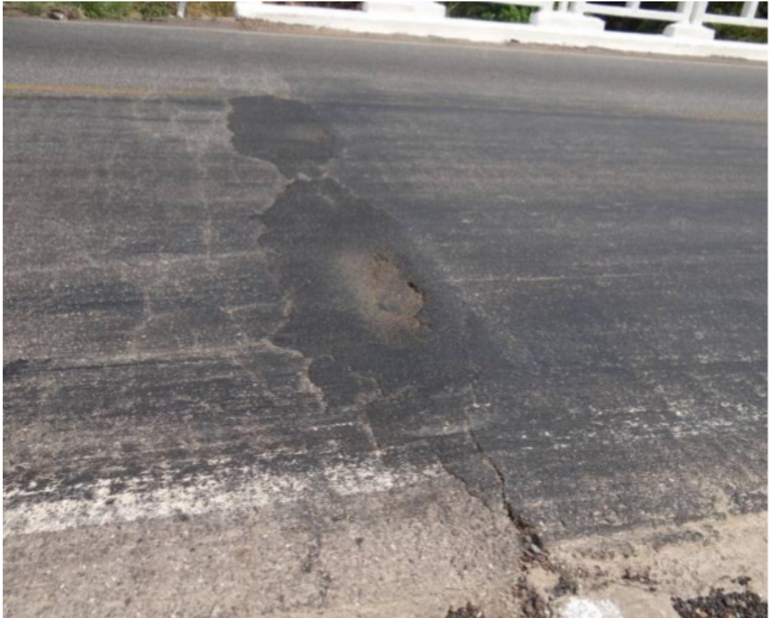
Figura 14 – Desnível na cabeceira da ponte.
