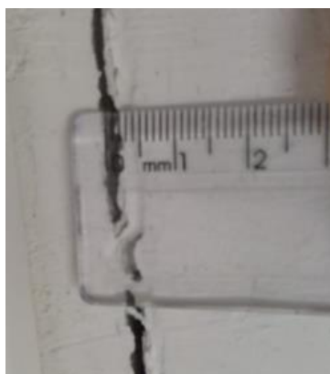
Figura 73 - Medição da abertura da fissura do detalhe "f"
