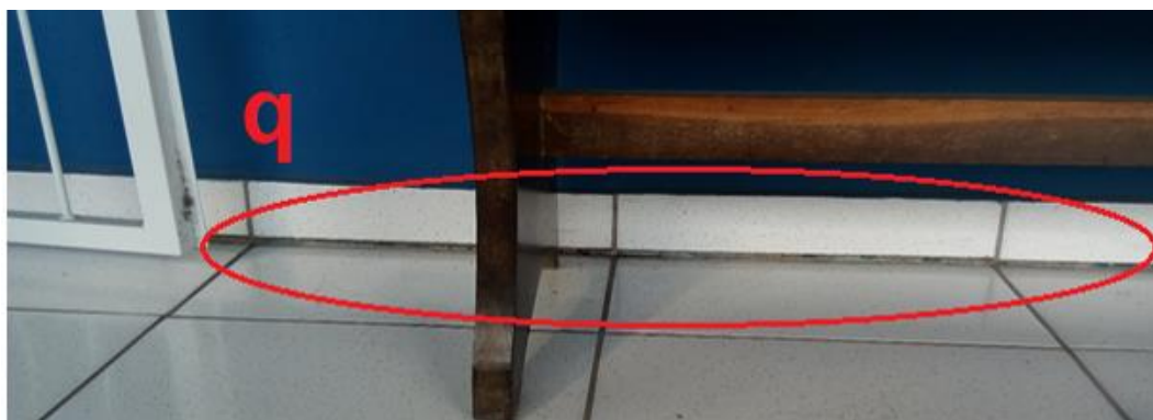
Figura 50 - Recalque na parte frontal da unidade
