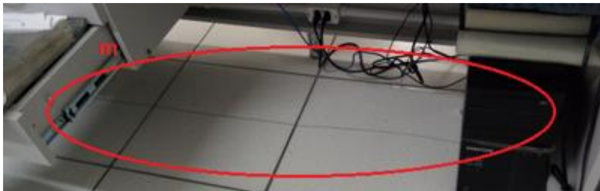
Figura 82 - Patologia realçada pelo detalhe "m"
