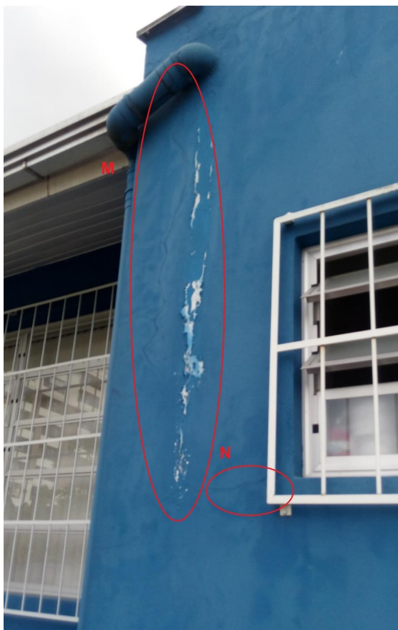
Figura 46 – Fissura e descascamento da tinta nos fundos da unidade
