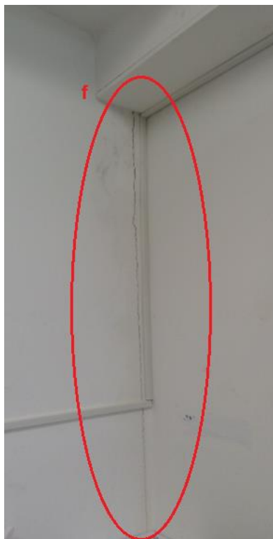
Figura 72 - Ampliação da patologia realçada no detalhe "f"
