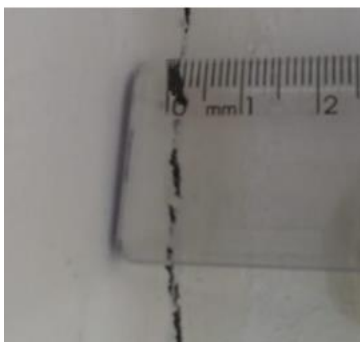
Figura 67 - Medição da abertura da patologia do detalhe "c"
