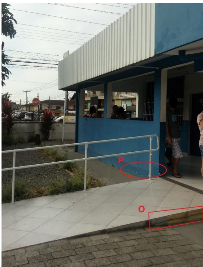
Figura 48 – Fissura e descascamento da tinta na parte frontal da unidade
