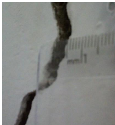
Figura 70 - Medição da abertura da manifestação patológica do detalhe "e"
