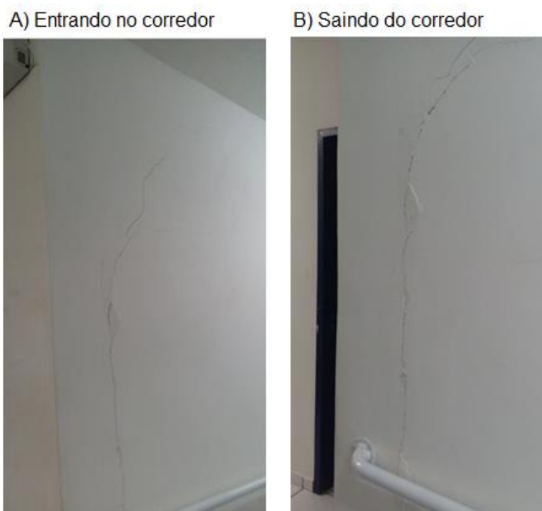
Figura 57 – Fissura visualizada conforme direção
