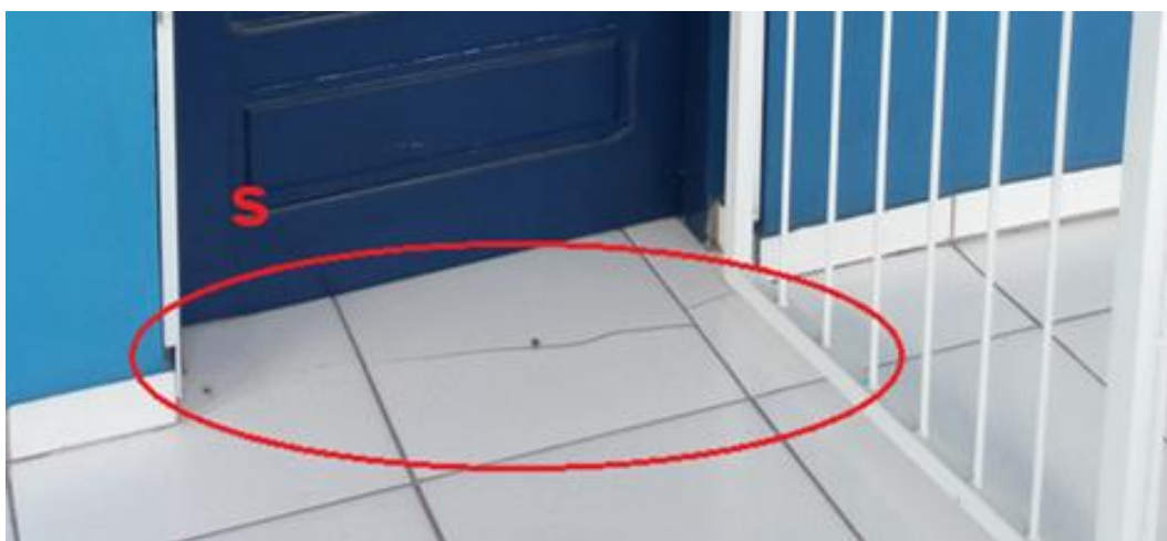
Figura 54 - Patologia na parte frontal da unidade
