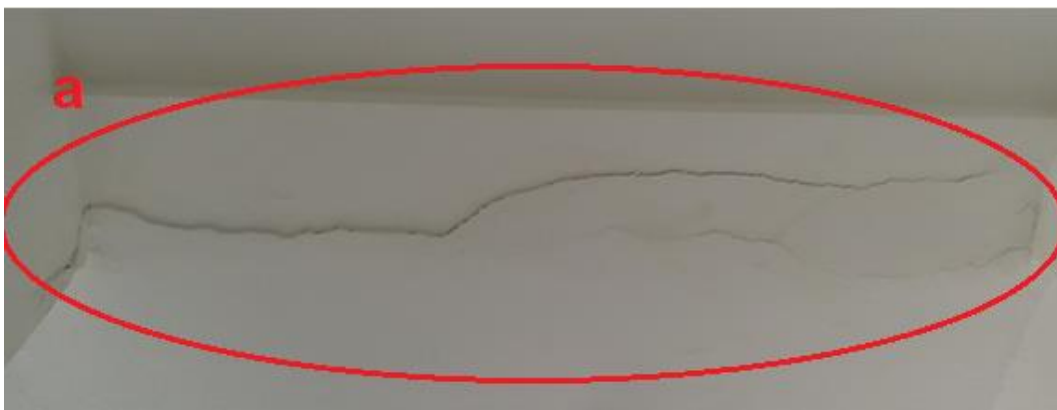
Figura 64 – Fissura na área interna destacada pelo detalhe "a"
