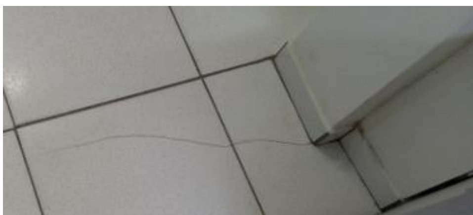
Figura 81 - Manifestação patológica em piso cerâmico
