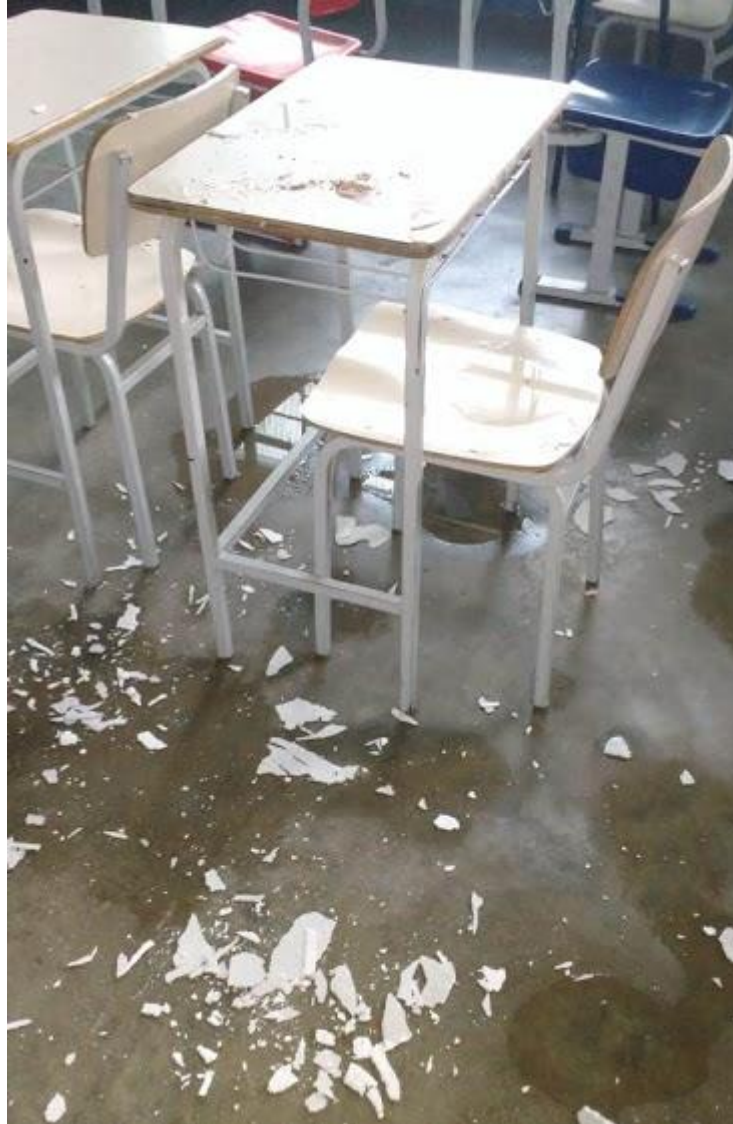
Imagem 11 – Sala de aula com goteiras, infiltrações e queda de fragmentos do teto. Retrato de problemas estruturais que põem em risco a comunidade escolar e interferem na qualidade do ensino. Fevereiro, 2018. Fonte: acervo do autor.
