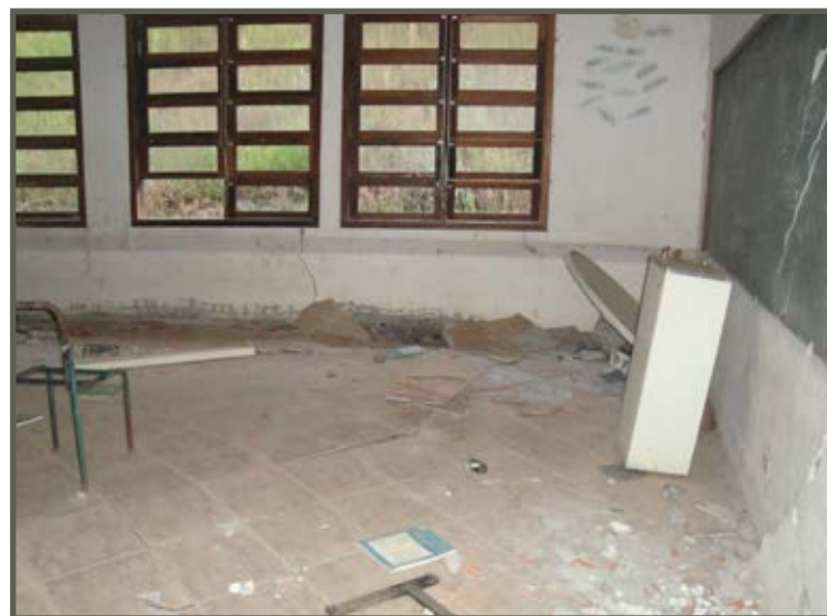
Piso cedendo numa sala da aula
