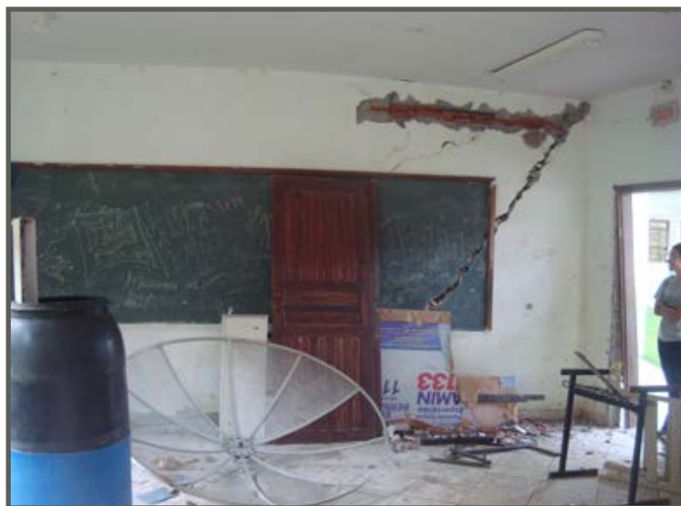
Rachaduras na sala de aula
