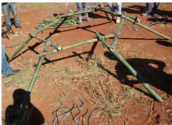
Amarração do topo da geodésica, construção de um hexágono de lado 90 cm.
