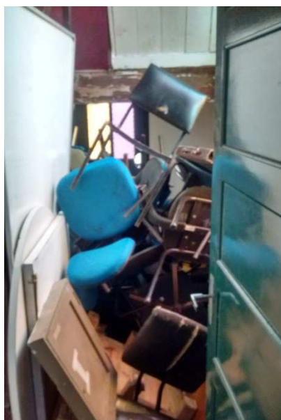
Figura 57 - Acesso as escadas - Teatrinho da UFSC
