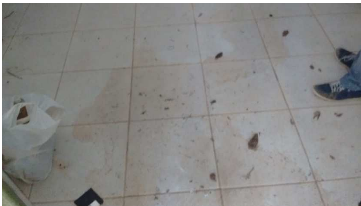
Figura 91 - Sala com mofo - CCS
