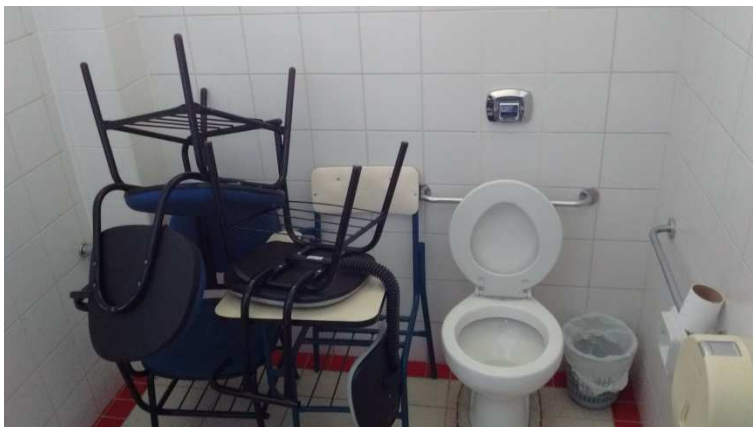
Figura 76 - Ponto de acúmulo em banheiro de deficiente físico - CDS
