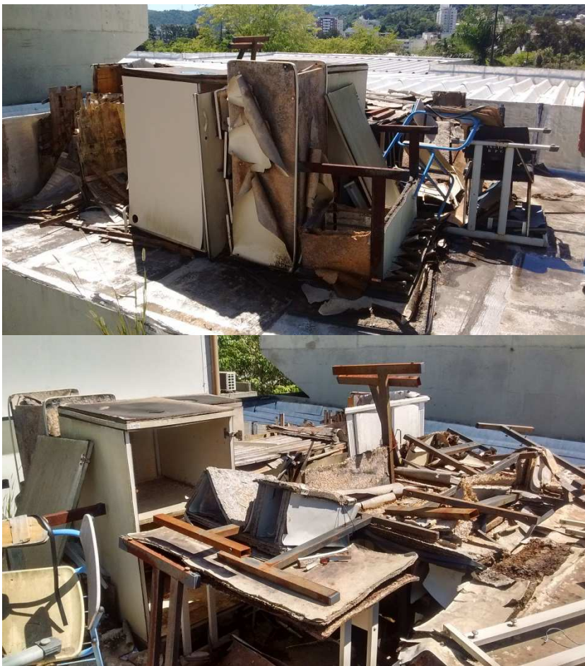
Figura 73 - Ponto de acúmulo de bens no telhado - CCJ
