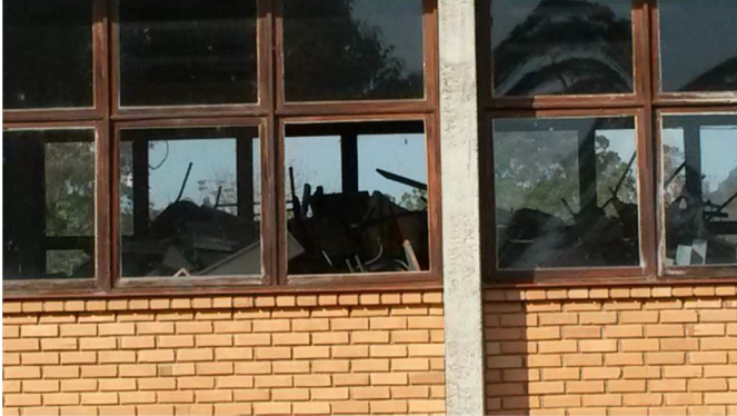
Figura 52 - Acúmulo de bens inservíveis em sala do CEFA 01
