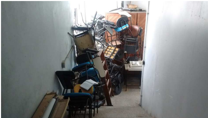
Figura 74 - Ponto de acúmulo no acesso ao telhado - CCE
