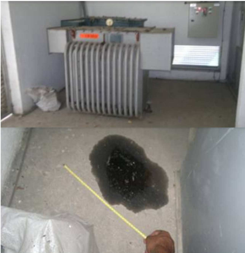
Figura 44 - Transformador e piso contaminado por PCBs
