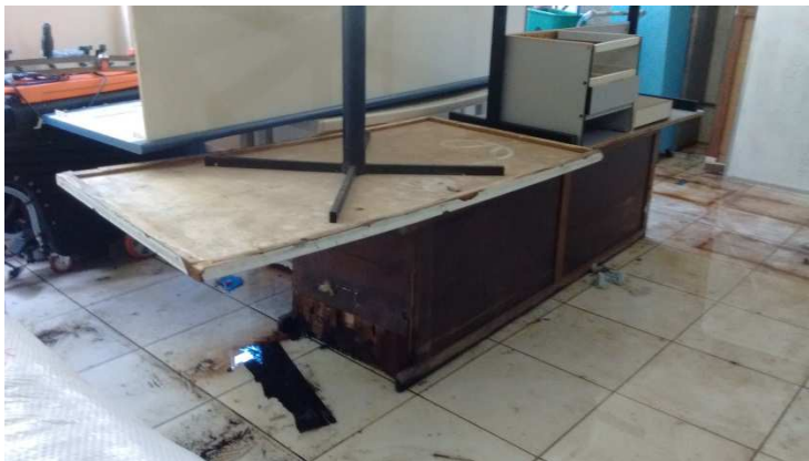
Figura 90 - Sala com infiltração - CA
