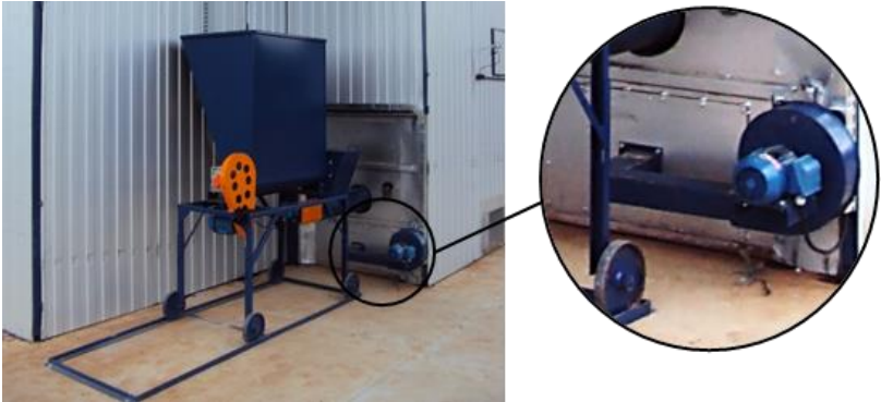
Figura 4.4 – Sistema de alimentação de combustível e em detalhe o ventilador que insufla o ar de combustão.
