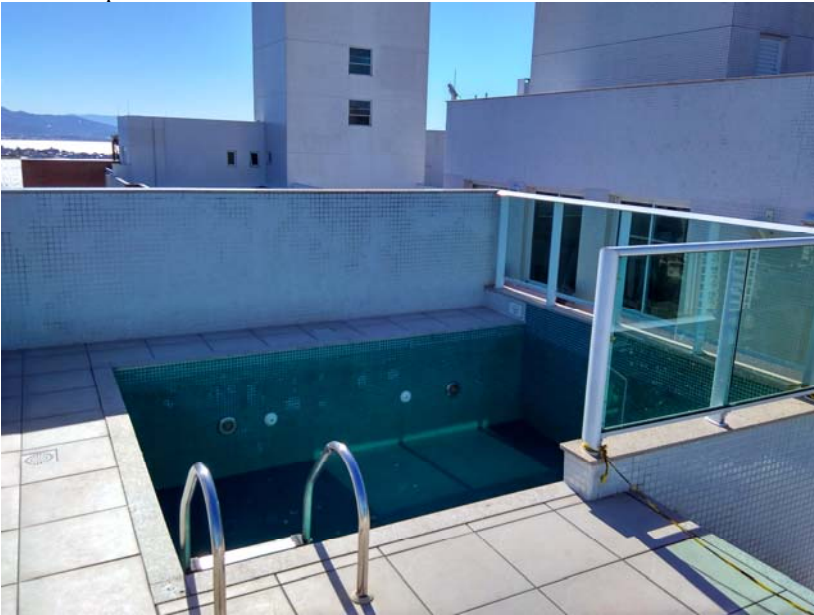
Figura 44 - Piscina externa: barreiras à paisagem e dimensões insuficientes para o uso compartilhado – Cond. “C”.
