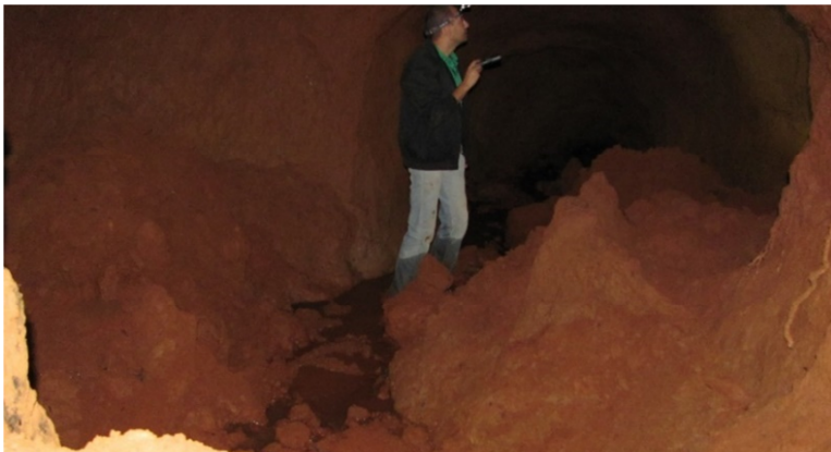
Figura 6 - Salão em forma de abóboda. Notar o desabamento constante de materiais do teto e das paredes, gerando grandes acumulações na base do túnel. Fonte: Acervo pessoal.
