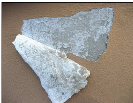
Figura 23 - Descascamento do sistema de pintura
