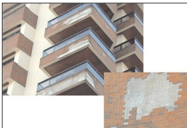
Figura 30 - Destacamento de peças cerâmicas em fachada.
