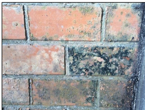
Figura 28 - Manchas causadas pela ação de microorganismos.
