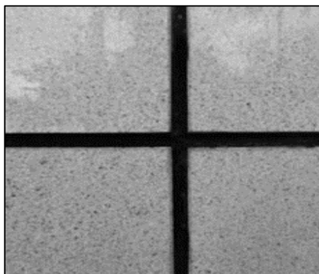
Figura 31 - Proliferação de fungos na argamassa de rejunte
