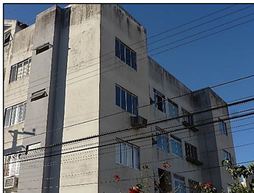
Figura 25 - Mofo em pintura.
