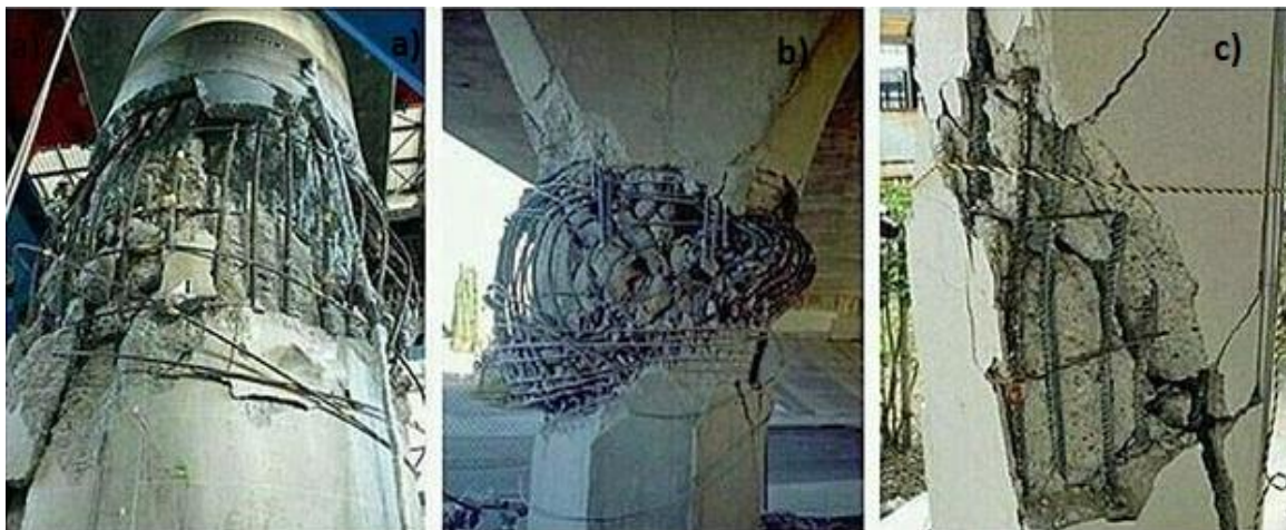
Figura 6 - Esforços mecânicos causados por mal dimensionamento dos pilares: a) Flambagem, b) Compressão, c) Cisalhamento.
