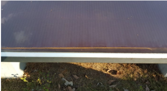
Figura 53 – Sujeira represada sobre módulo FV pela presença de moldura, após intensa aplicação de água sobre o mesmo.
