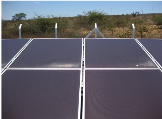
Figura 39 - Exemplo de não-homogeneidade entre módulos FV de um mesmo subsistema (a-Si).
