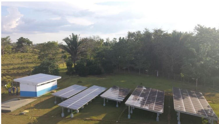
Figura 27 – Vista geral do sistema FV Buritis-RO (Vista E).
