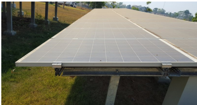
Figura 46 – Detalhe do perfil de sujeira aderida ao subsistema p-Si. A sujeira aderida não representa sombreamento ao módulo FV.
