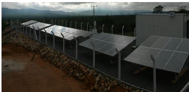
Figura 26 – Vista geral dos sistemas FV instalados (vista NO).
