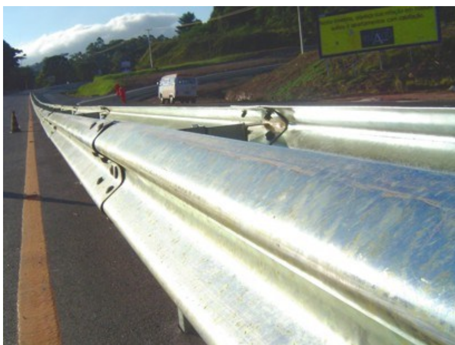
Figura 4 – Exemplo de dispositivo de segurança: defesa metálica
