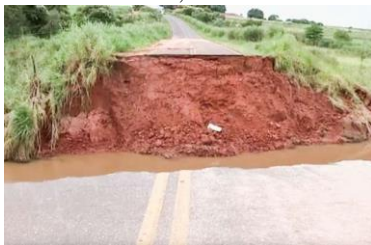
Figura 16: Rompimento de pista pela água na rodovia Alberto Lahoz de Carvalho, Sorocaba (SP).
