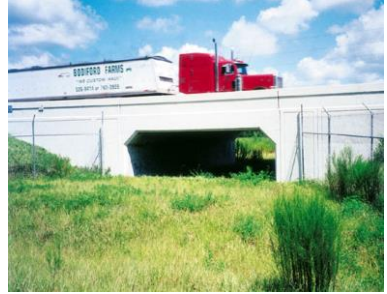
Figura 27: Passagem inferior para ursos na Flórida, Estados Unidos. Estrada Estadual 46. Fonte: eMORFES, 2012.
