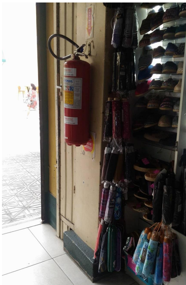
Figura 17: Extintor localizado próximo à área externa
