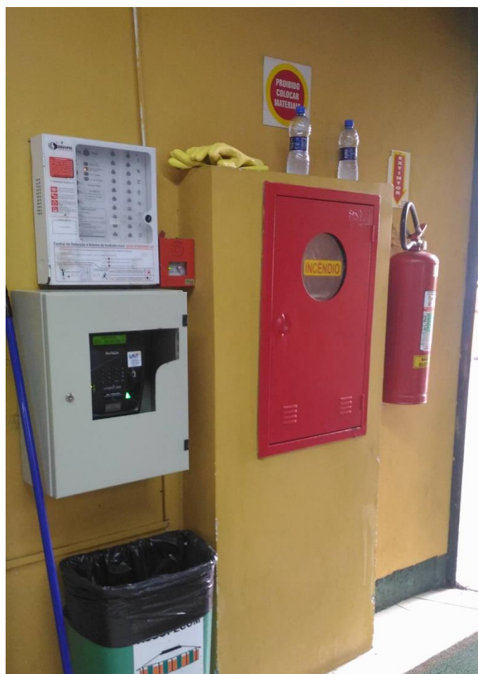
Figura 18: Localização da central de alarme e acionador “push button”
