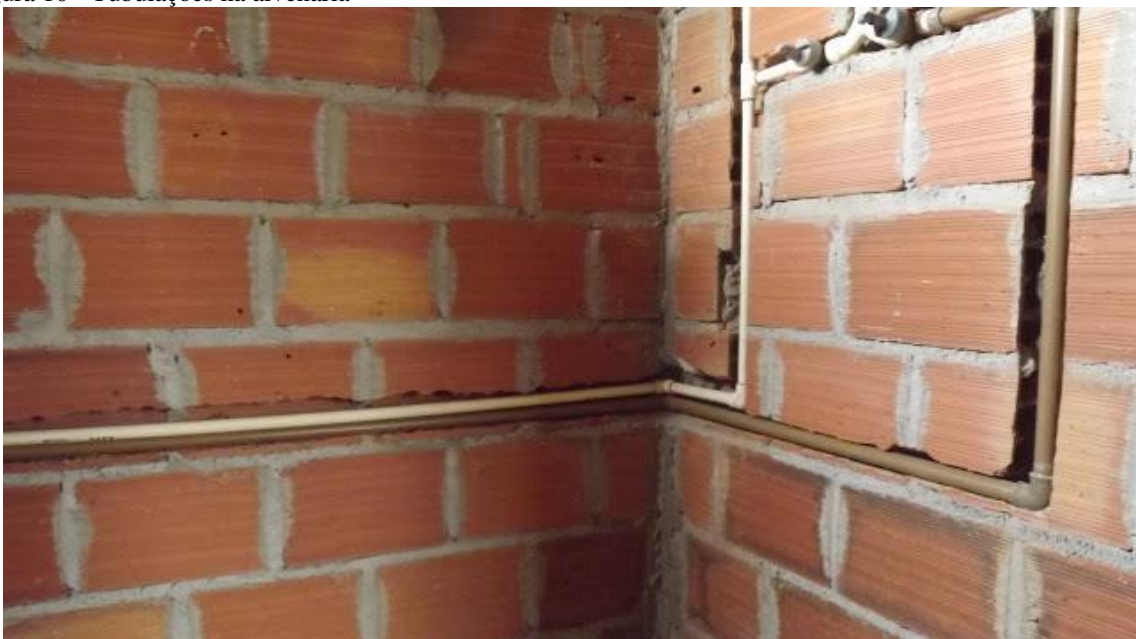
Figura 10 - Tubulações na alvenaria
