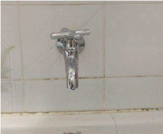
Foto 2: Torneira da lavanderia, ala 1.
