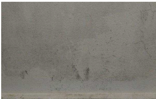
Foto 18: Parede voltada para o exterior, ala 7.
