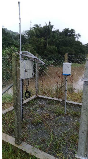
Figura 1 – Estação de monitoramento.
