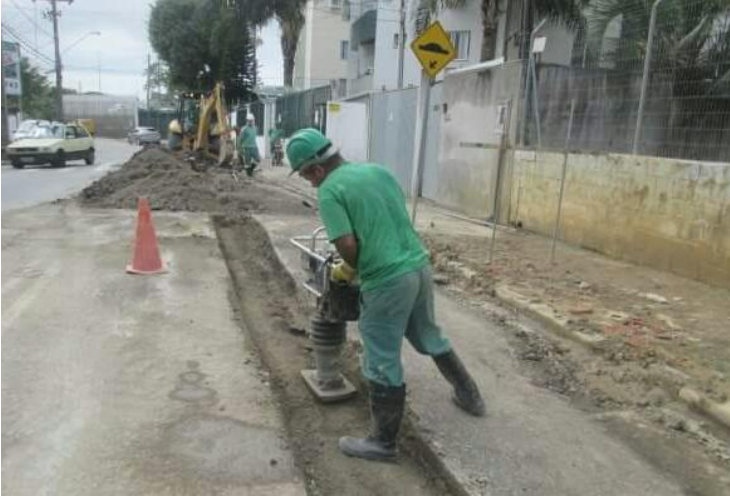
Figura 7: Recomposição da pavimentação com o auxílio de uma compactador de percussão (Fonte: Elaborado pelo autor).
