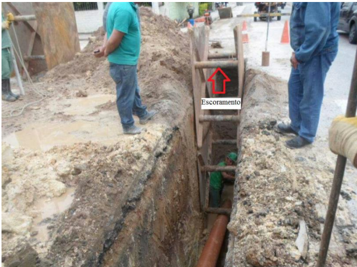
Figura 5: Escoramento utilizado para o assentamento do coletor de esgoto (Fonte: Elaborado pelo autor).
