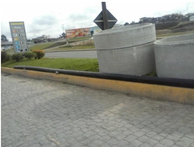
Figura 17: Resultado de duas soldas entre três tubulações destinado a uma travessia de 16 metros (Fonte: Elaborado pelo autor).
