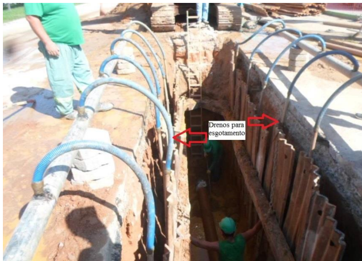
Figura 4: Drenos para esgotamento para abaixar o nível do lençol freático (Fonte: Elaborado pelo autor).
