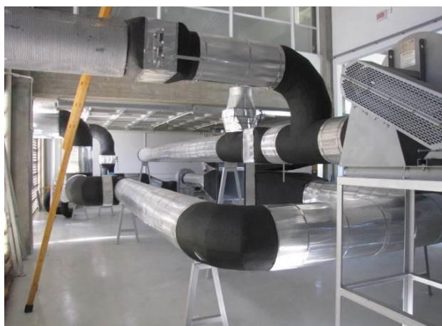
Figura 13: Bancada de testes de trocadores de calor gás-gás (BANCUN) com termossifões
