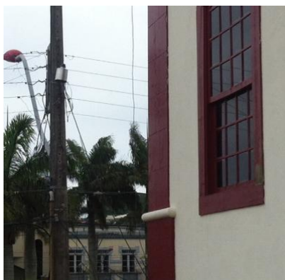
Figura 61: Fiação externa exposta
