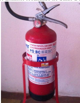
Figura 83: Extintor localizado no Salão Boa Ventura
