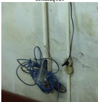
Figura 62: Precariedade nas instalações
