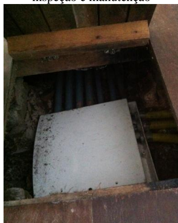
Figura 85: Alçapão de acesso para inspeção e manutenção
