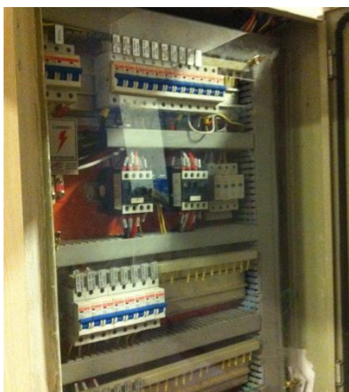
Figura 84: Quadro de distribuição
