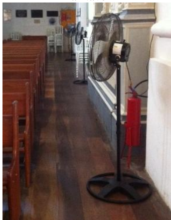
Figura 82: Único extintor localizado na Nave
