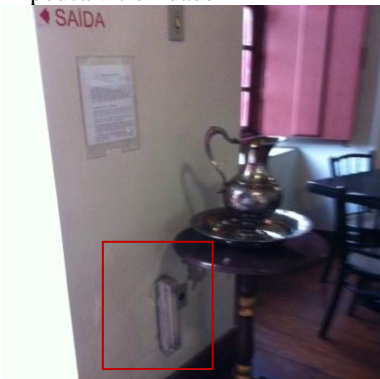
Figura 63: Iluminação de emergência com pouca visibilidade
